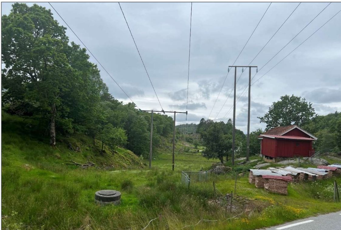
Figur 5-12. Dagens 110 kV-ledning (til venstre) krysser Årikstadveien nord for Ytre Eikeland, parallelt med en 22 kV-ledning (til høyre).
