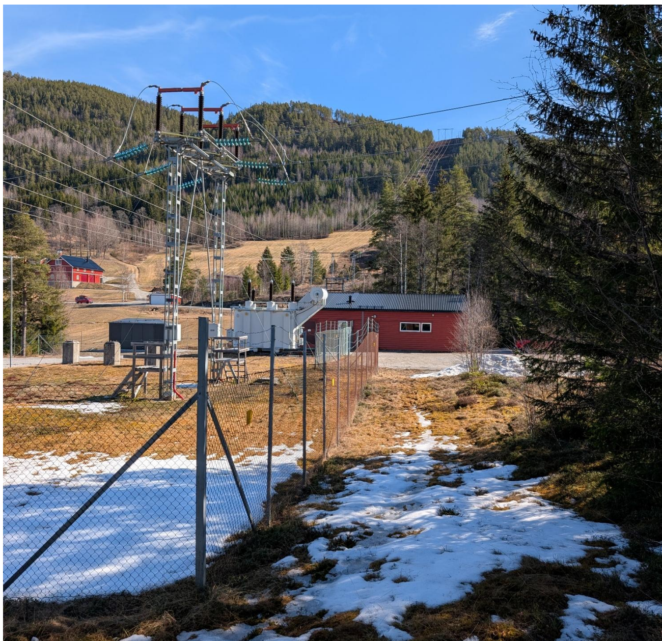
Figur 6 Gjerdet rundt transformatorstasjonen
