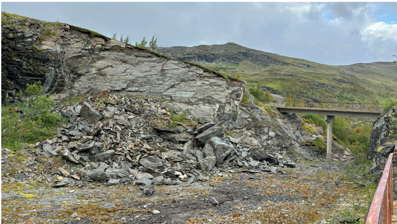
Figur 21: Den største utrasinga i flaumløpet. Toppen av skråninga bør reinskast før massane fjernast.
