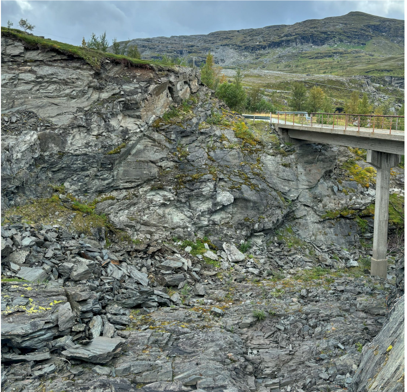
Figur 15: Sørleg brufundament. Sprekker med fall ut i flaumløpet.
