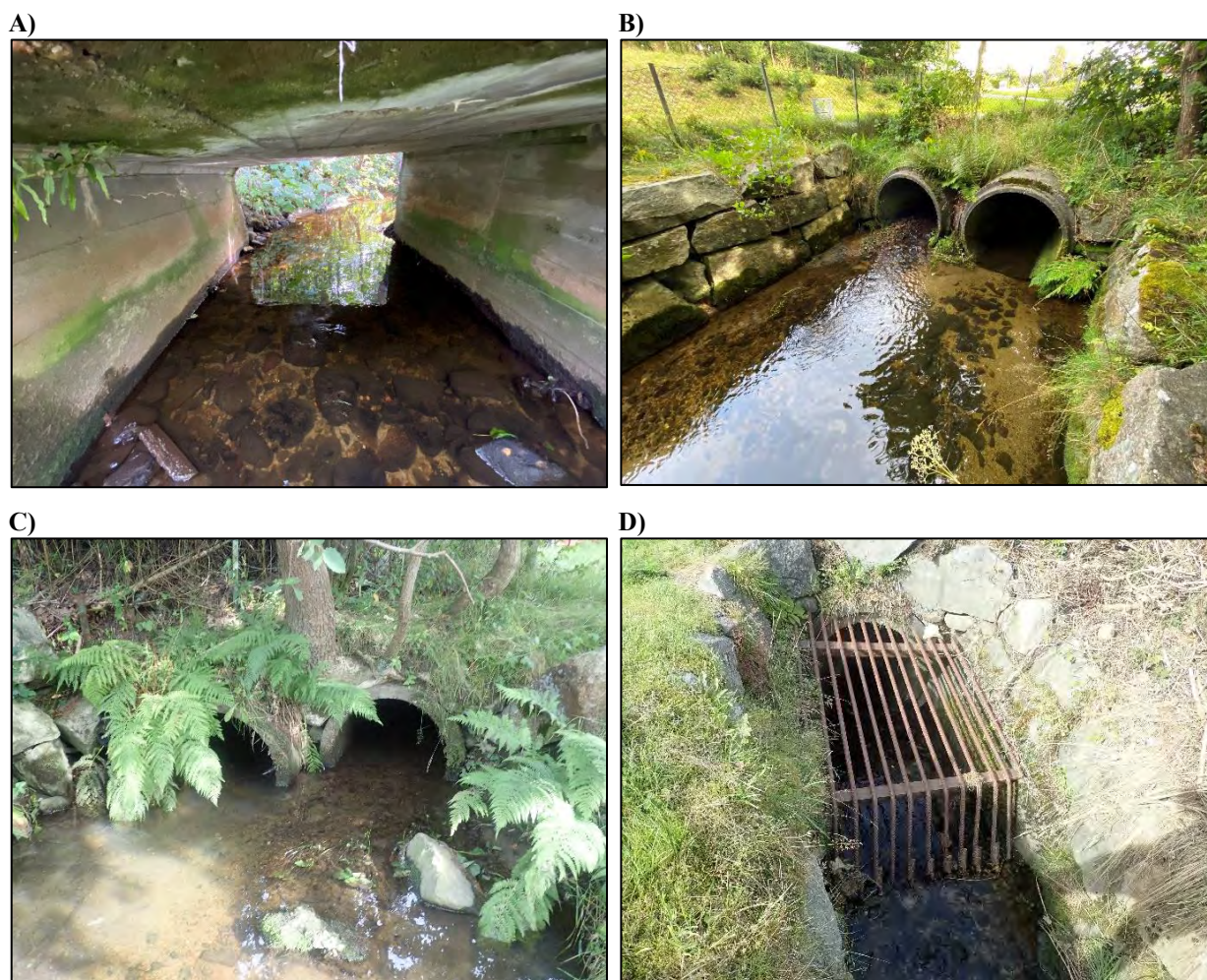
Figur 5.2. Vandringshindre og bekkelukkinger i Riskaåna: A) Kulvert i segment 5 har naturlig bunnsubstrat og er enkel for fisk å passere. B) Bekkelukkingen under Riskaveien er lang, men inngangen i rørene er uproblematisk. C) Øverst i Riskaåna, i segment 25, avsluttes det tilgjengelige, anadrome habitatet med en lang bekkelukking. Det ble observert en del ørret i kulpen foran bekkelukkingen. D) Det nederste røret i sidebekken, i segment B1, er krevende å passere, blant annet grunnet et smalt metallgitter ved innløpet.
