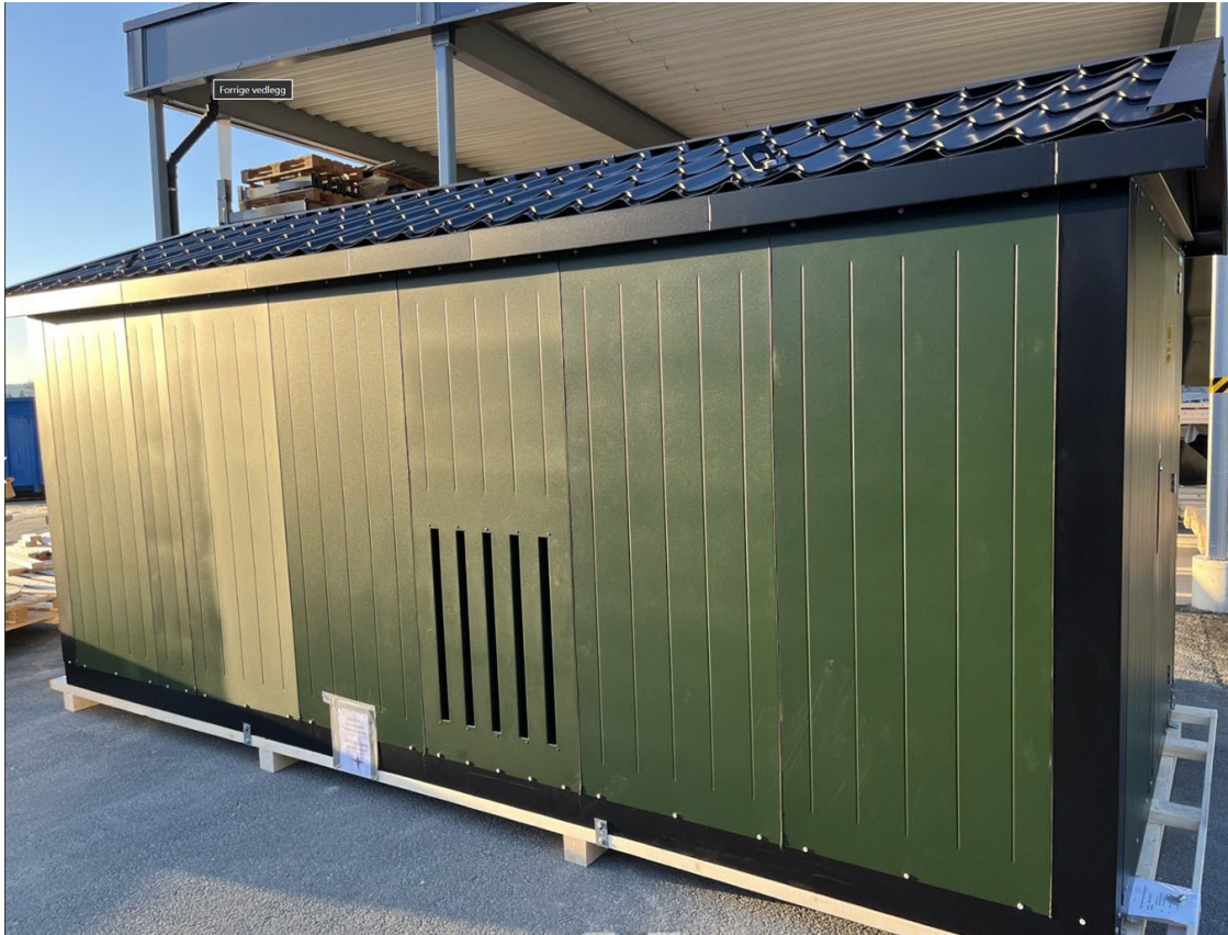
Figur 14: Illustrasjonsfoto av netstasjon. Bygget vil inneholde høyspent rom, transformator og utstyr for betjening av ventil samt overvåking av slipp av minstevannføringa.
