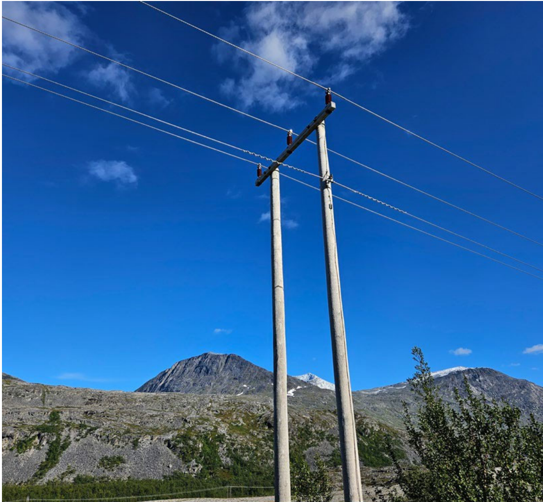
Figur 6: Eksisterende 22 kV linje som kabel tilkoples.
