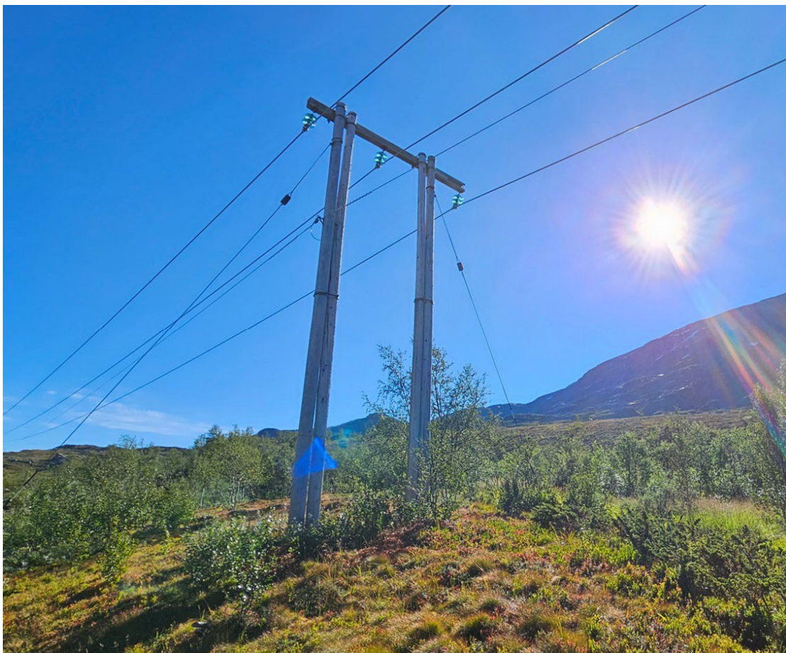
Figur 11: Mast 101 på eksisterende 22 kV høyspent linje Ofoten trafo – Nordkraftverk hvor ny kabel tilkoples.
