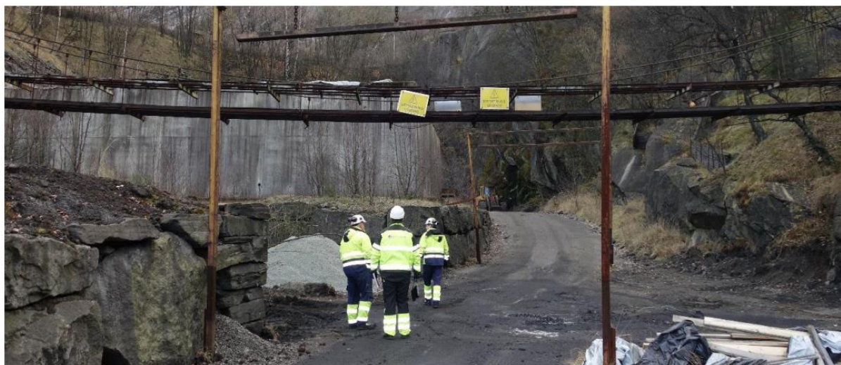
Bilde 1: Kabelbro nord for TTI som er føringsvei for dagens 66 kV oljekabler til TTI. Det føres også distribusjonsnettkabler over broen.
