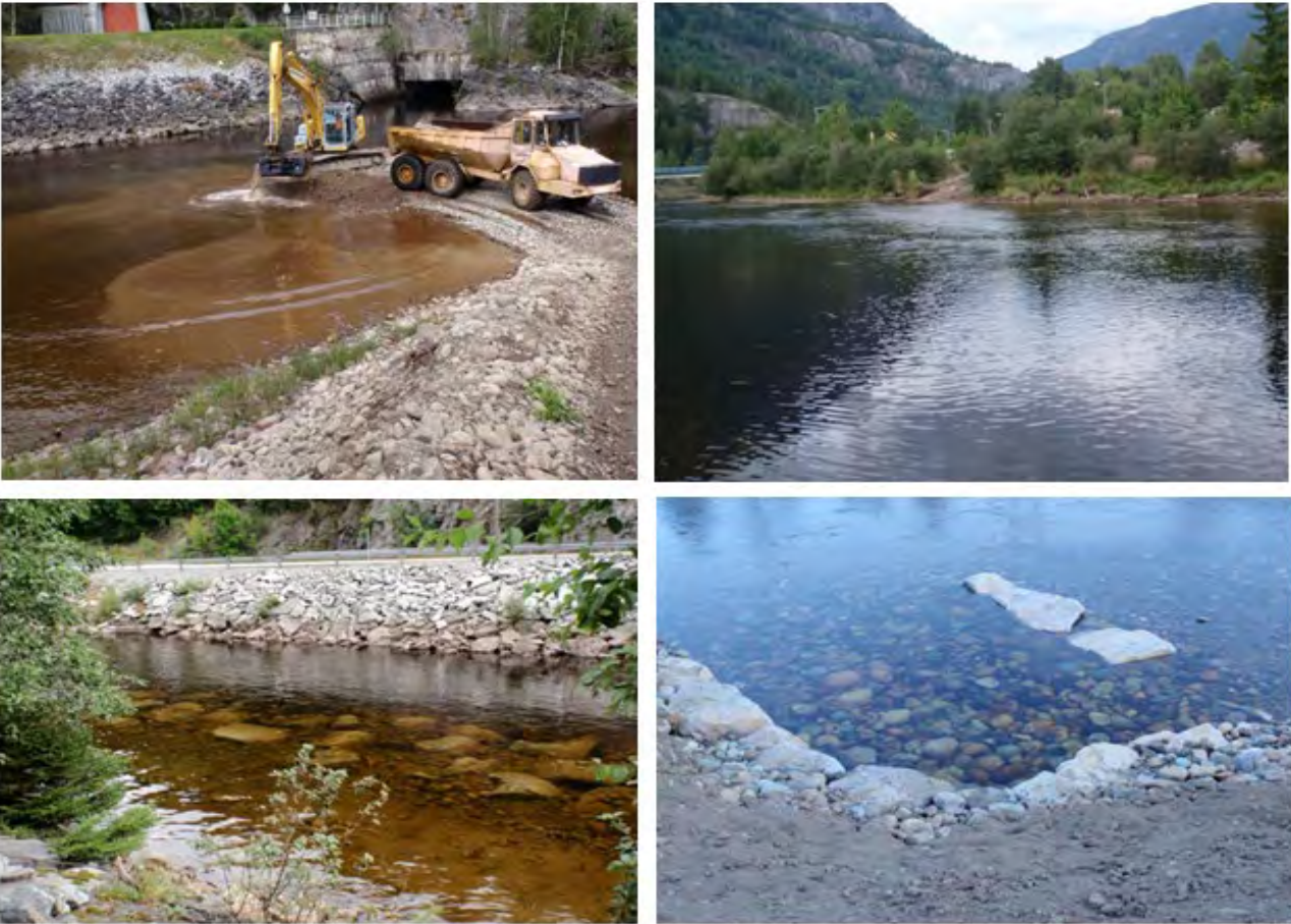
Figur 16. Øverst til venstre; senkning av grusøyren utenfor avløpstunnelen til kraftstasjonen, øverst til høyre; senkning av elvekantareal nedstrøms bro til kraftverket med ca. 20 cm, nederst til venstre; steinsetting i elva langs E134, nederst til høyre; etablering av kile ved stasjon 5 (fra Kildal 2012; Kildal 2013).
