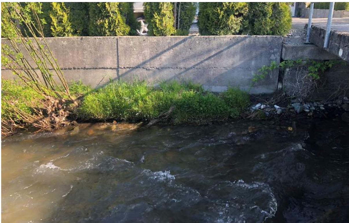
Figur 1.26 Eksisterende erosjonssikring ved bru til Fremovegen 8 i form av støpt betongstøttemur. Bunn i noe grad naturlig erosjonssikret med stein/grus. Vann fremstår litt misfarget. Erosjon klassifiseres som «lite erosjon» (poengscore 1). Bilde: IMG_4728, Jakob Bitsch Jensen, 19.05.2022, bilde tatt mot nord.
