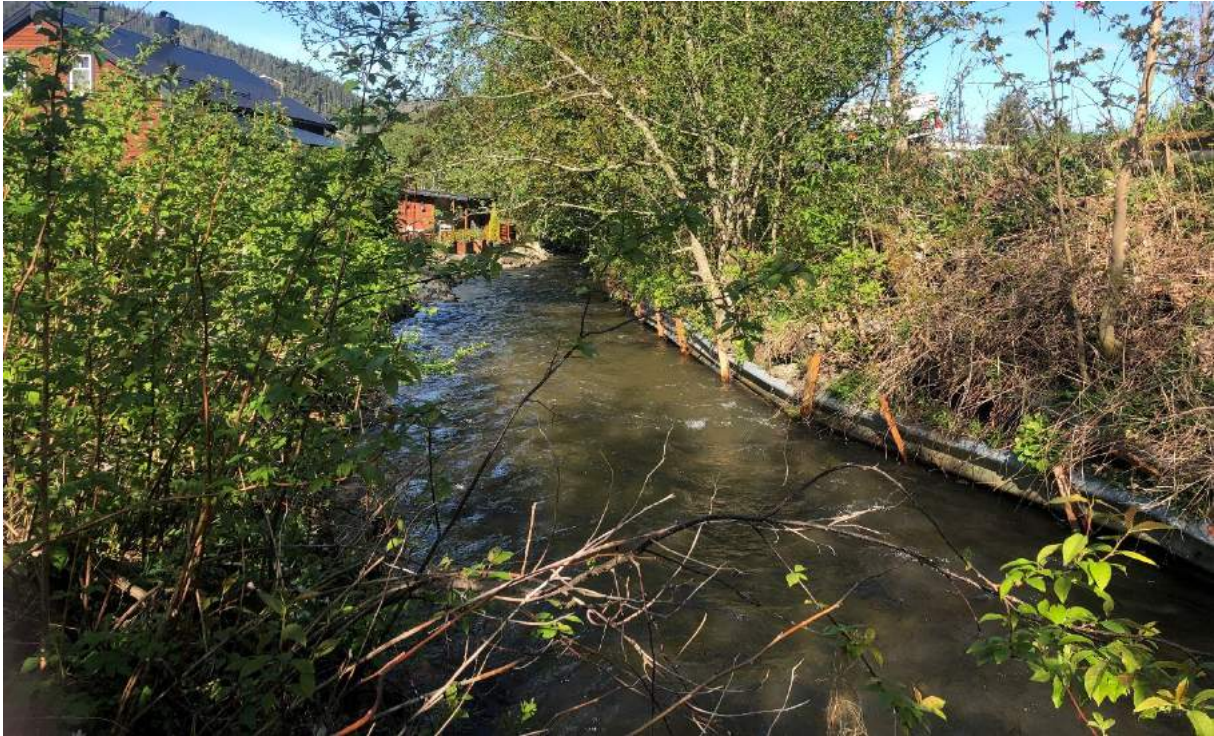
Figur 1.23 Eksisterende erosjonssikring av autovern og bakenforliggende stein (og div. annet.). Enkelte av pelene som holder igjen autovern fremstår klar for utskifting. Bunn i noe grad naturlig erosjonssikret med stein/grus. Vann fremstår litt misfarget. Erosjon klassifiseres som «lite erosjon» (poengscore 1). Bilde: IMG_4737, Jakob Bitsch Jensen, 19.05.2022, bilde tatt mot nord.
