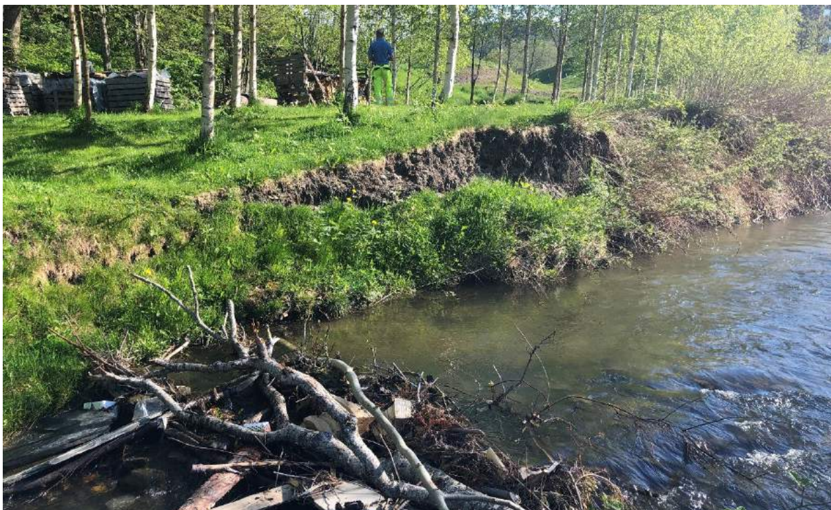
Figur 1.32. Erosjon i yttersving, mindre utglidning. Sider i noe grad erosjonssikret med vegetasjon og bjørk på rader. Grener tilsynelatende lagt ut for å unngå graving i yttersving. Bunn i noe grad naturlig erosjonssikret med stein/grus. Vann fremstår litt misfarget. Erosjon klassifiseres som «lite erosjon» (poengscore 1). Bilde: IMG_4766, Jakob Bitsch Jensen, 19.05.2022, bilde tatt mot nord.
