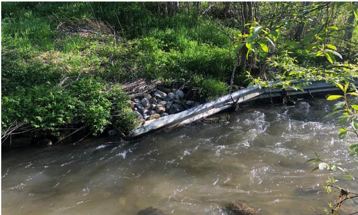
Figur 1.25 Enda et eksempel på eksisterende erosjonssikring av autovern og bakenforliggende stein. Bunn i noe grad naturlig erosjonssikret med stein/grus. Vann fremstår litt misfarget. Erosjon klassifiseres som «lite erosjon» (poengscore 1). Bilde: IMG_4735, Jakob Bitsch Jensen, 19.05.2022, bilde tatt mot nord.
