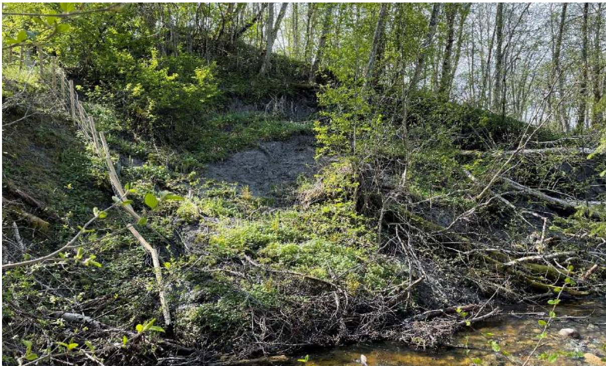
Figur 1.16 Stor overflateglidning (bredde og lengde > 10 m og dybde rundt 1-2 m). Gjerde står på skakke. Bunn fremstår som «naturlig erosjonssikret» med stein og vegetasjon, men ved stor vannføring spises det av skråningsfoten (bestående av leire) på sørlig side. Erosjon klassifiseres som «kraftig erosjon» (poengscore 3). Bilde: IMG_1423, Per Mo, 19.05.2022, bilde tatt mot sør.
