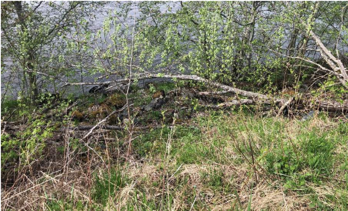
Figur 1.6 Eksisterende gjengrodd plastring av sprengstein og moreneblokk langs Gaula. Bilde: IMG_4987, Jakob Bitsch Jensen, 19.05.2022, bilde tatt mot vest.
