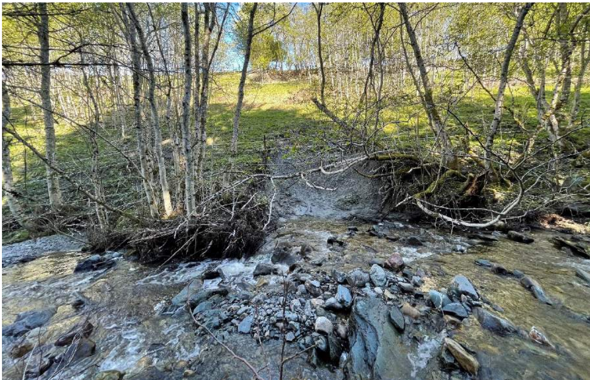
Figur 1.12 Lokal overflateglidning (bredde og lengde < 10 m og dybde ca. 1 m). Bunn og til dels sider fremstår som «naturlig erosjonssikret» med stein og vegetasjon, men ved stor vannføring spises det av skråningsfoten (bestående av leire) på nordlig side. Erosjon klassifiseres som «noe erosjon» (poengscore 2). Bilde: IMG_1408, Per Mo, 19.05.2022, bilde tatt mot nord.
