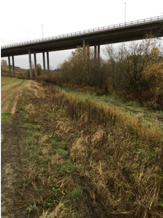
Figur 2-11: Hauger 4. Mye vegetasjon. Lite erosjon.
