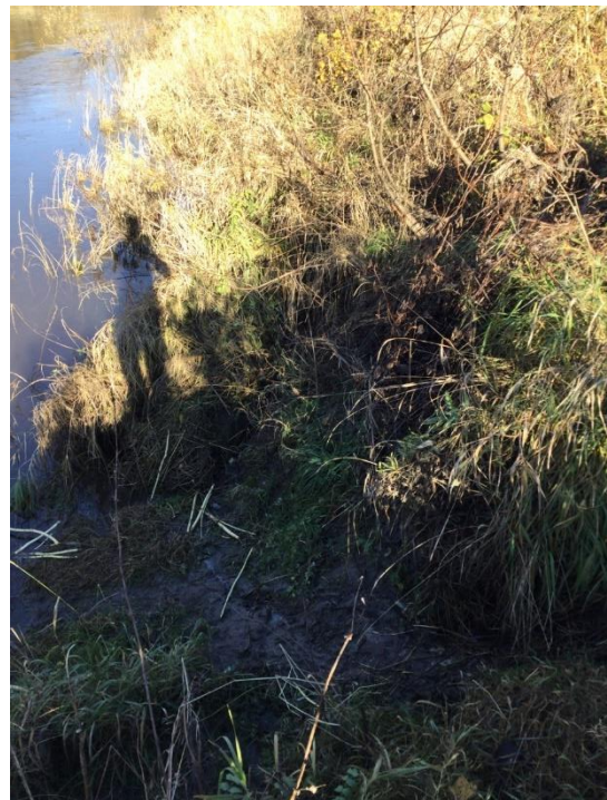
Figur 2-56: Profil 1a. Mot sør. Utglidning ned i elv. Noe erosjon vurdert fra før.
