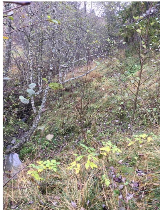
Figur 2-43: Profil 2. Mot sørvest. Stor utglidning. Noe erosjon.
