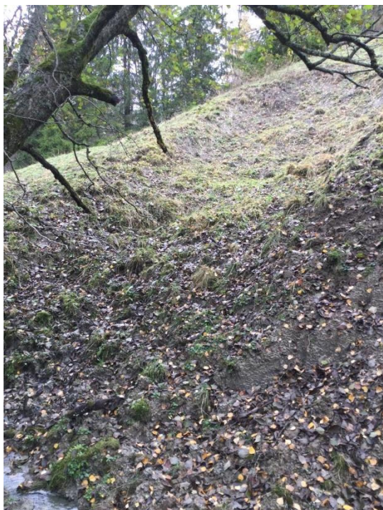
Figur 2-5: Stor utglidning vest for profil 7. Noe erosjon.
