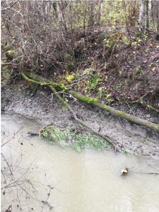
Figur 2-9: Hauger 7. Mot nordøst. Stor rotasjonsutglidning. Kraftig erosjon.
