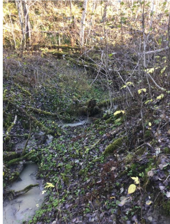
Figur 2-61: Profil 1 mot sørøst. Utløp sideravine. Mindre utglidninger. Noe erosjon.
