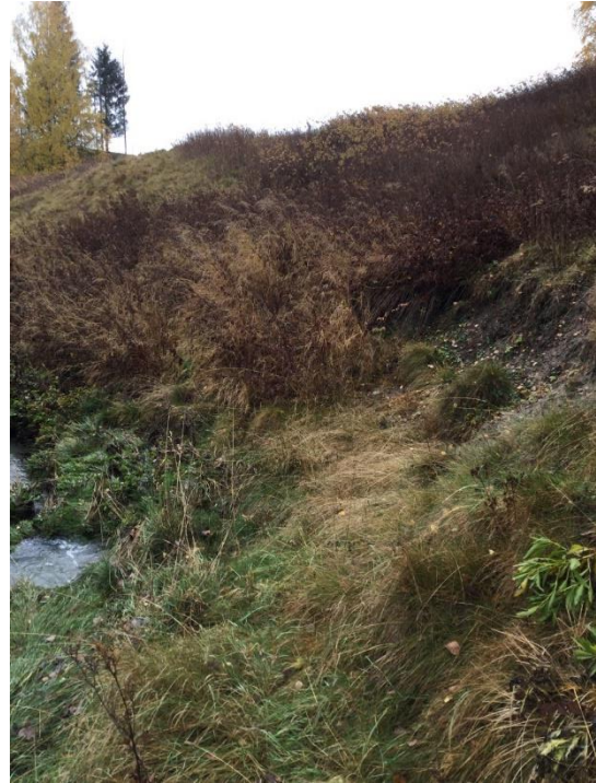
Figur 2-48: Profil 5. Mot sørvest. Stor rotasjonsutglidning. Noe erosjon.
