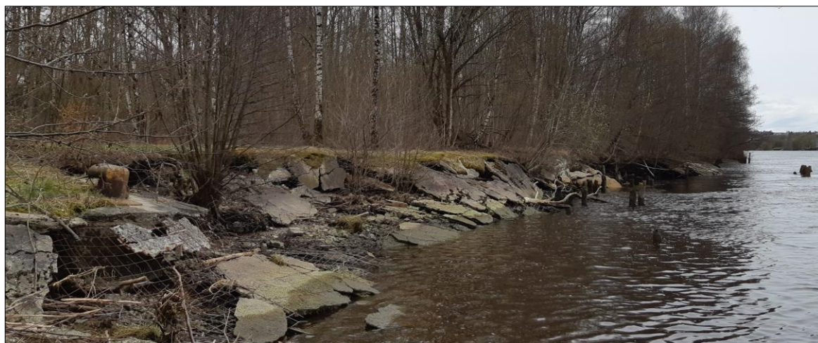
Figur 4.14: Står ved det tidligere raset og tar bilde mot sydvest (Befaring 23.04.2024).
