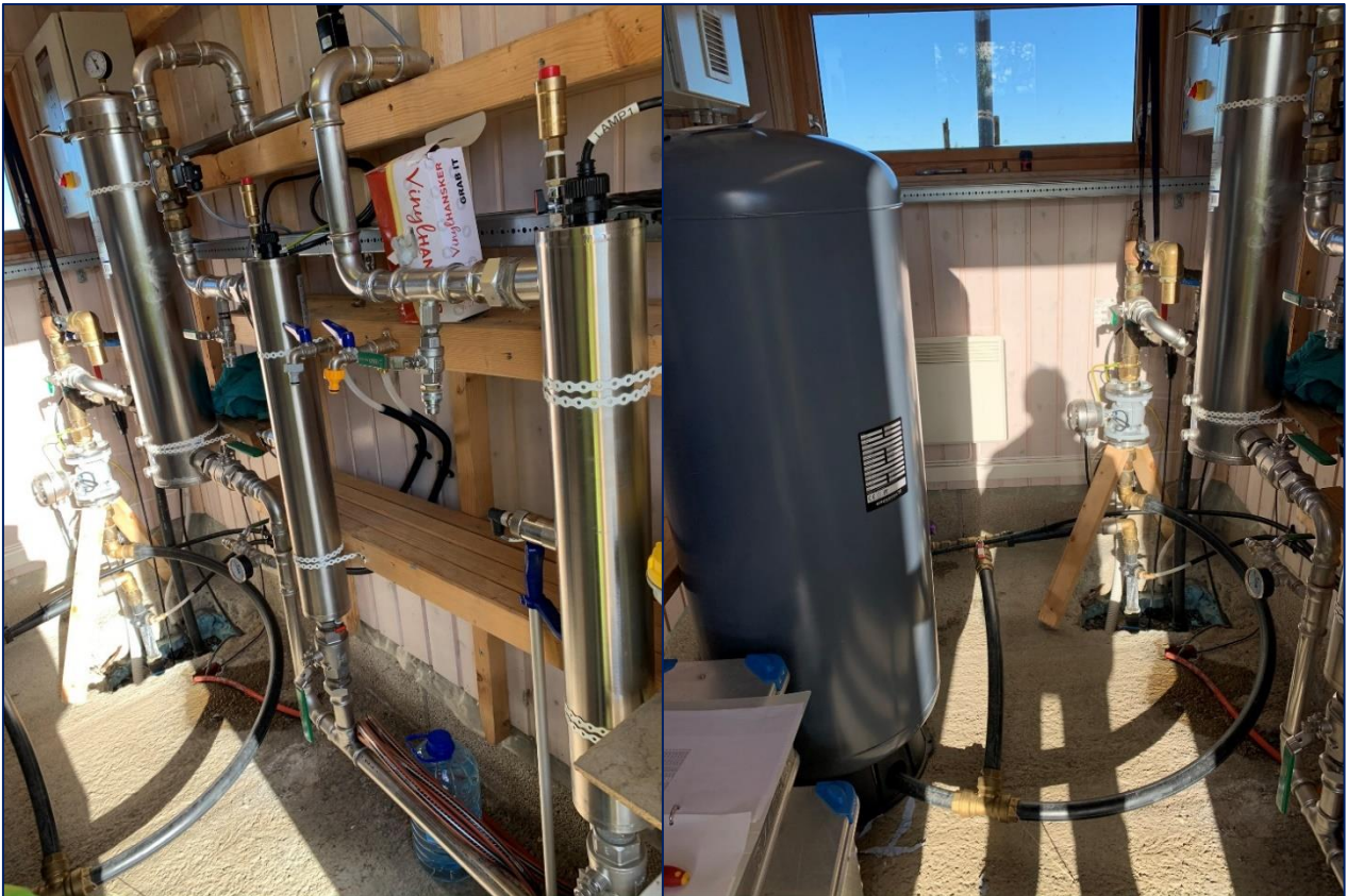
Figur 5. GB01 og vannbehandling ved Klevmoseterhøgda vannverk. Vannbehandlingen består av partikkelfilter og UV.
