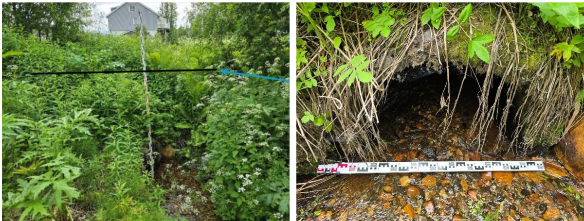
Figur 4: Bilde av bekken oppstrøms Strandveien (venstre) med plasseringen til innløpet markert med blå pil. Bildet til høyre viser innløpet til røret. (Foto: oppdragsgiver)
