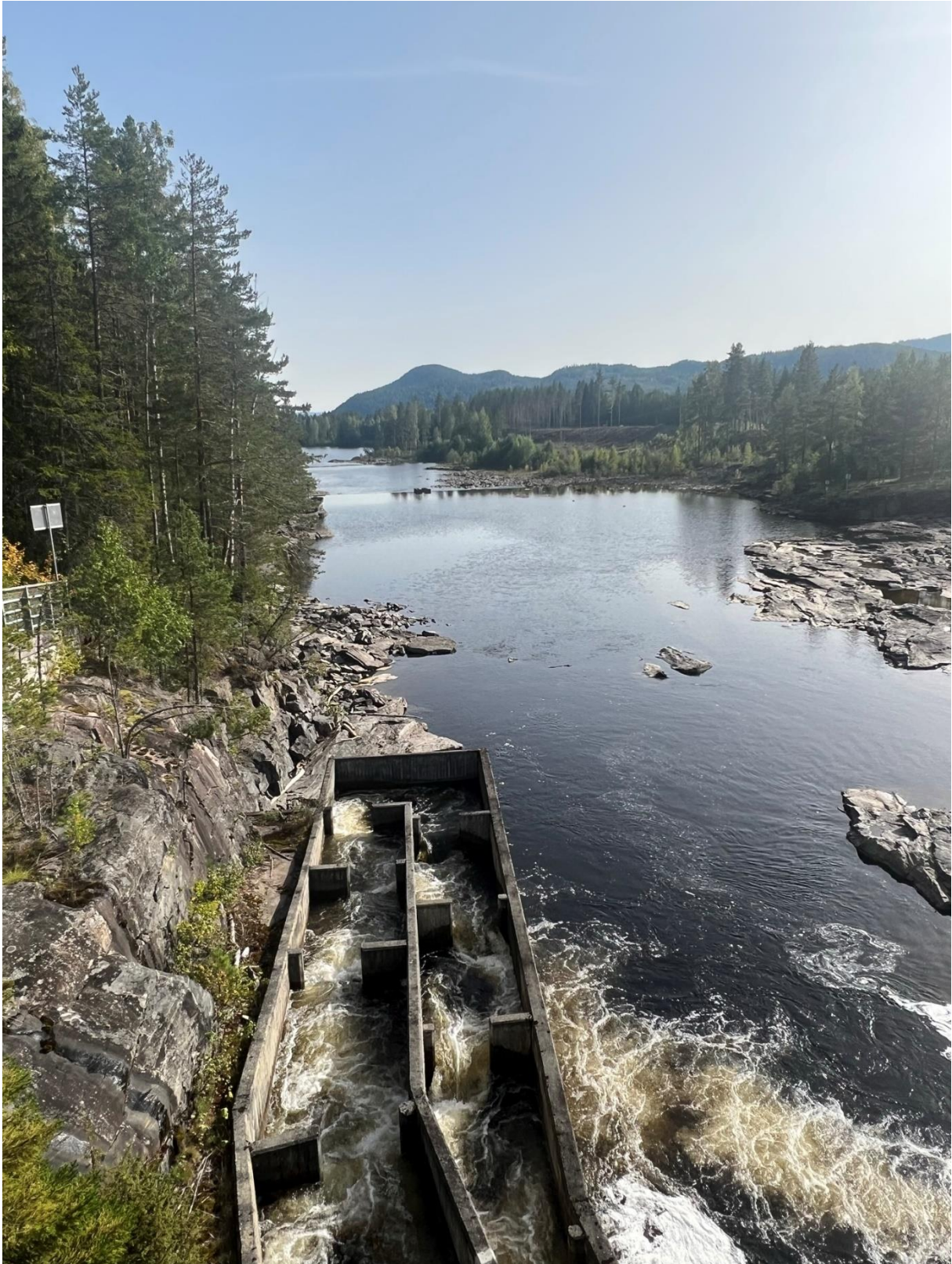
Fisketrappa i hoved-dammen. Terskeldam nr. 1 sees like nedenfor.
