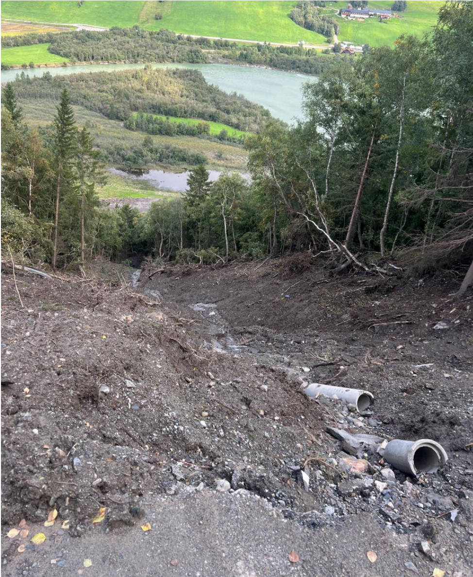
Figur 19: Skredet sett fra fylkesveien, stikkrenne i midten..
