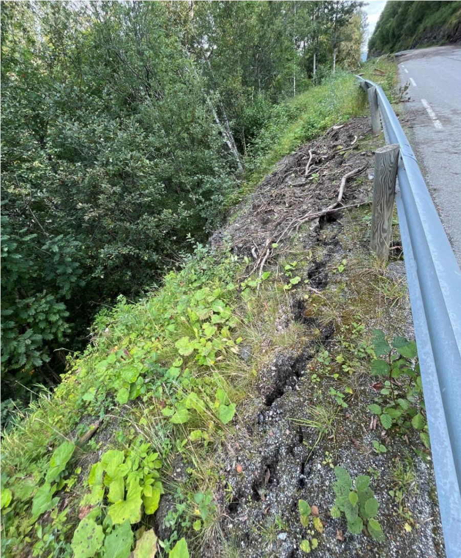
Figur 21: Sprekkedannelser i naborennen mot vest. Skredløpet er i bakgrunnen.
