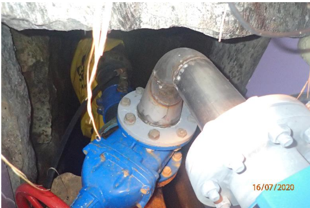
Bilde 12, tapperør i ventilhuset
