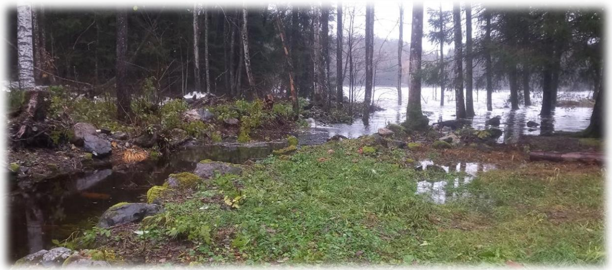
Bilde 13. Viser hvorfor det er nødvendig å bygge opp igjen ledemurene i nedre del for å hindre at flommer ødelegger området ved Lindlandsvannet. rørgate (Flom 4 november 2023)
