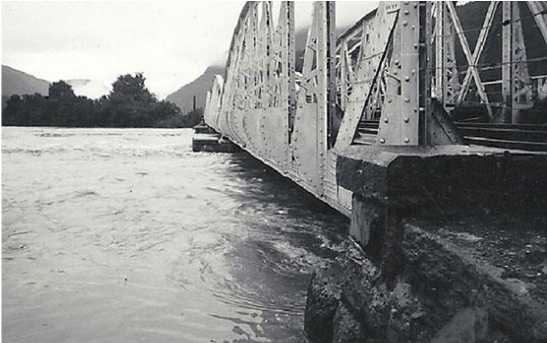
Figur 3. Otta jernbanebru under flommen 1938
