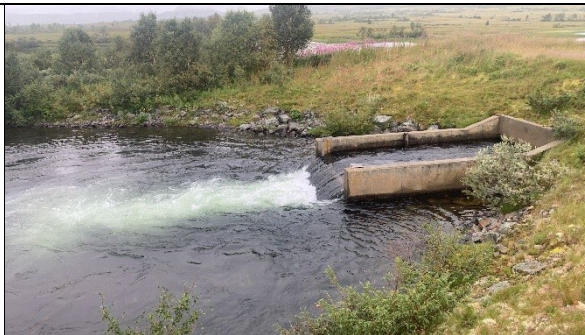
Utløpskanal fra Lislevatn med målekulp hvor terskelen må byttes ut.
