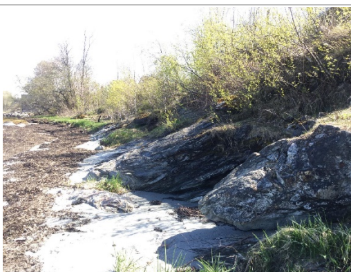
Berg i dagen (BiD) ved jernbanefylling, ingen erosjon
