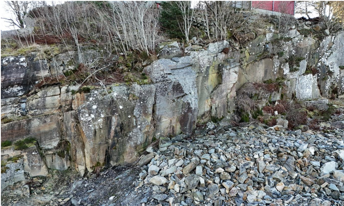
Figur 6: Skrentparti som er mer oppsprukket, mulig som følge av sprenging/pigging. Bildet er tatt nord for Hanøyvegen 501 mot sørvest. Det er også en løsmassefylling på toppen av skrenten, og stabiliteten til denne er ikke vurdert.
