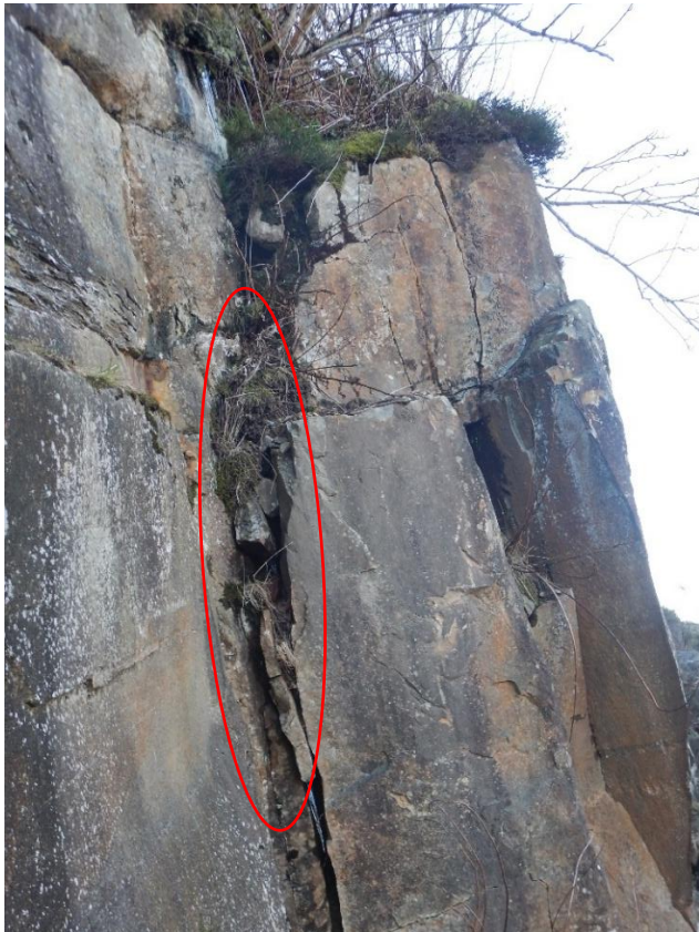
Figur 12: Bildet viser bl.a. steilt Ø-V sprekkesett som har helning på like i underkant av 90 grader mot nord der vi kan se åpen sprekk med fylling (rød ellipse), i skrent nedafor Hanøyvegen 499 og 501. Bildet er tatt mot vest.
