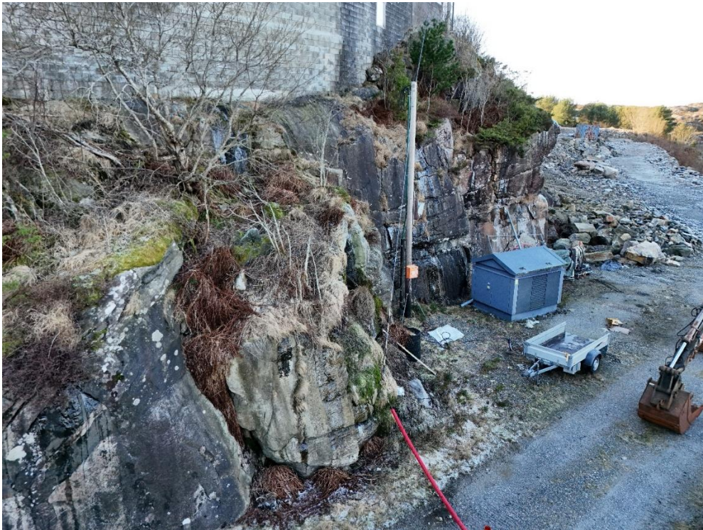
Figur 4: Deler av bergmassen som er lite oppsprukket, med dyp forvittringshud og ingen opplagte tegn til utfall av nyere dato. Bildet er tatt øst for Hanøyvegen 499, mot nordvest. Adressenummer kan leses av i registreringskartet (Figur 11).
