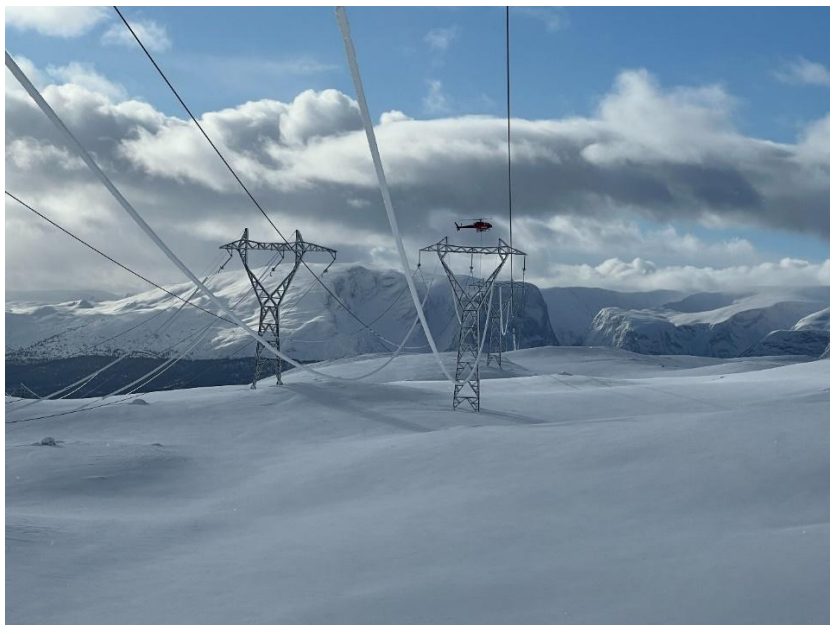
Figur 6: Bilde for illustrasjon (Sogndal-Hove). Bildet viser hvordan nediset topplinen siger ned mellom fasetlinene. Om mulig benyttes helikopter for å skrape is fra topplinen på spenningsløst anlegg.
