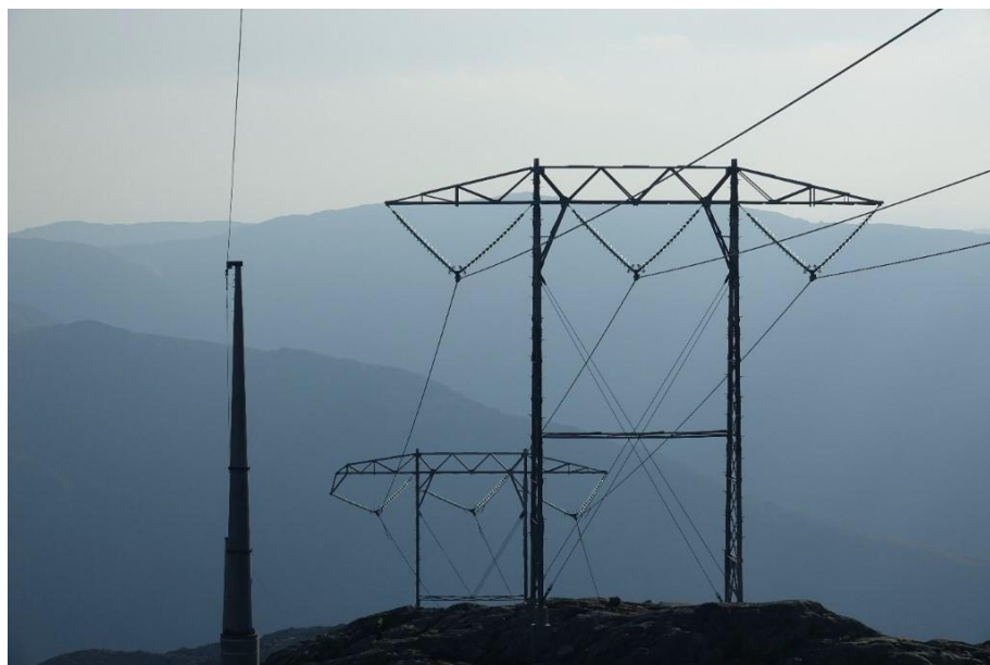
Figur 3: Eksempel på monomast ved siden av en standard 420 kV-ledning.
