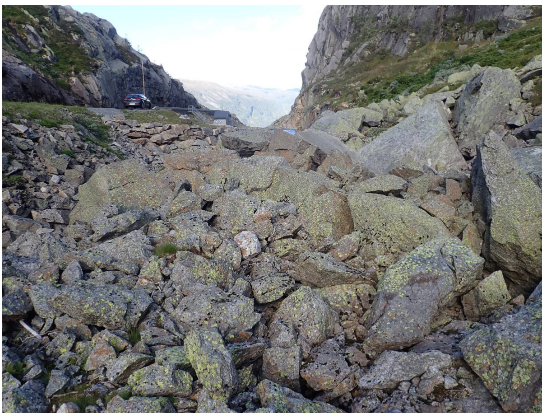
Figur 20 Steinrøys og inntakshus
