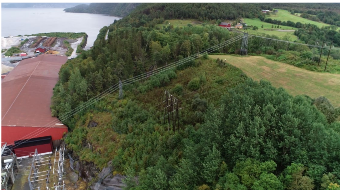
Figur 3: Eksisterende 22 kV kraftledning inn mot Holla
