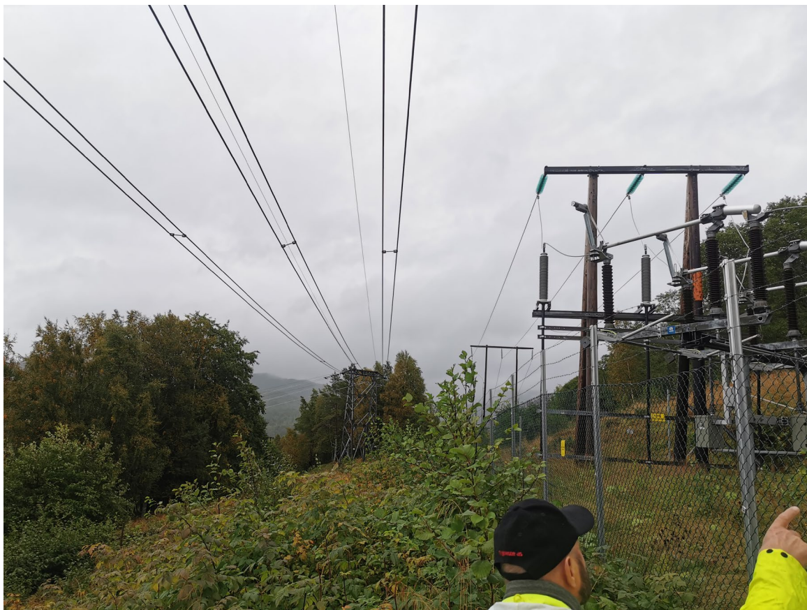
Figur 4: Eksisterende 22 kV-ledning sett fra mast nr 7 mot vinkelmast nr 8.
