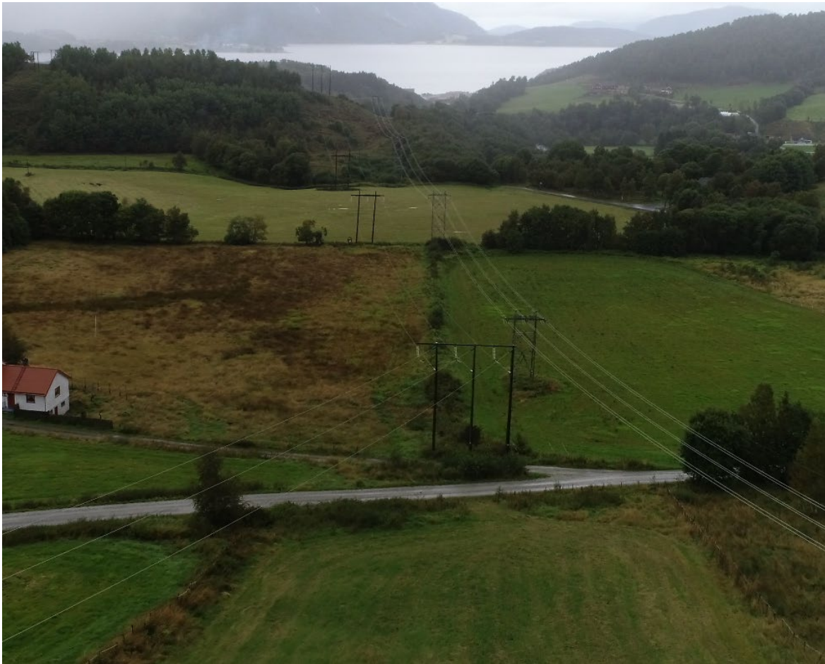
Figur 2: Eksisterende 22 kV og 132 kV kraftledninger
