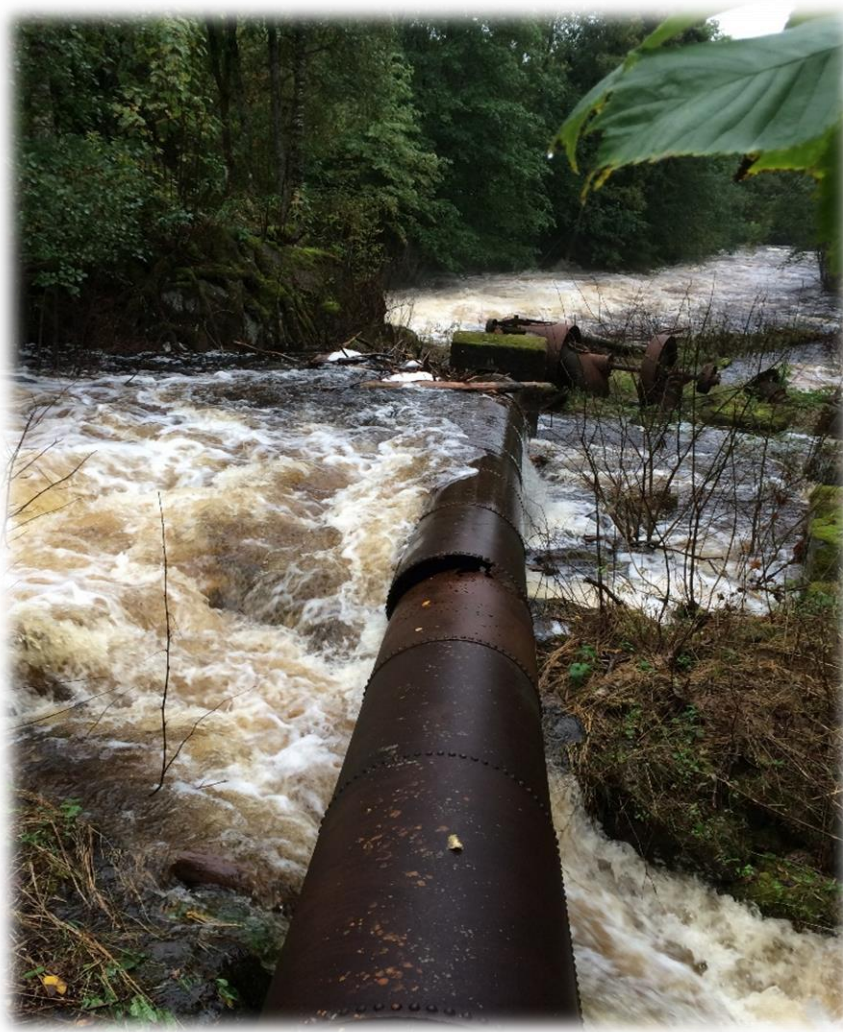
Bilde 4 Viser hvorfor det er nødvendig å bygge opp igjen ledemurene for å hindre at flommer ødelegger rørgate og kraftstasjon (Flom 18. september 2015)
