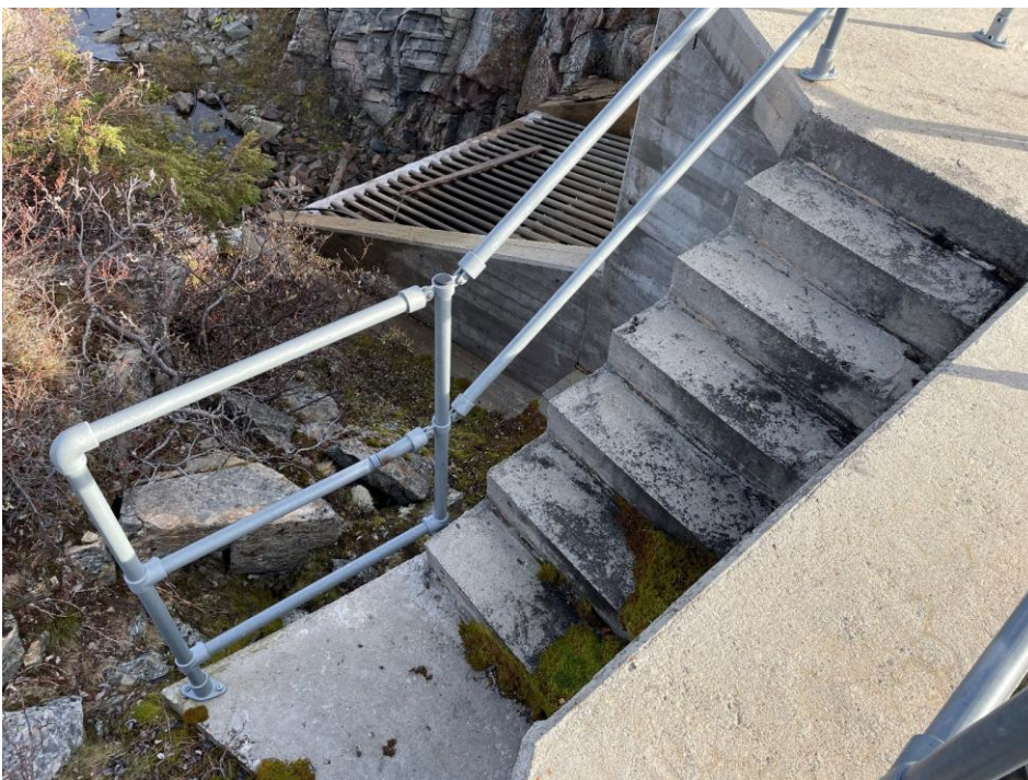
Bilde 4 Trapp på venstre side ved adkomst til bekkeinntaket
