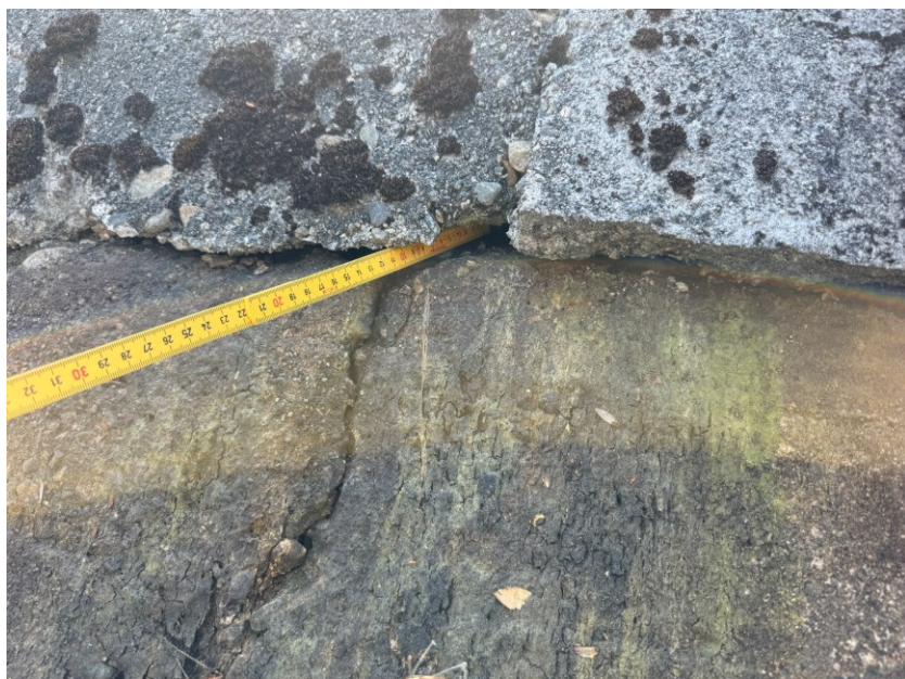
Figur 7-4: Omfang av skade i nedstrøms del av dammen, ved omstøpt drenasjerør.
