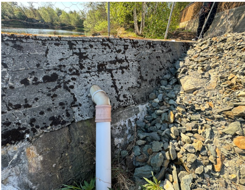
Figur 7-2: Omstøpt drenasjerør, sett fra nedstrøms side.
