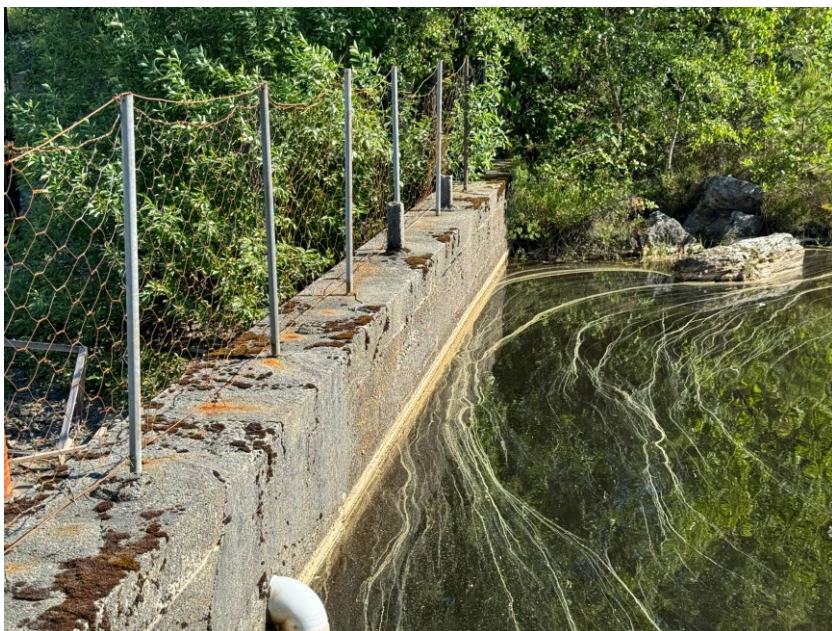
Figur 7-5: Dammens gjerde over damkronen. Fare for tilstopping ved større flommer.
