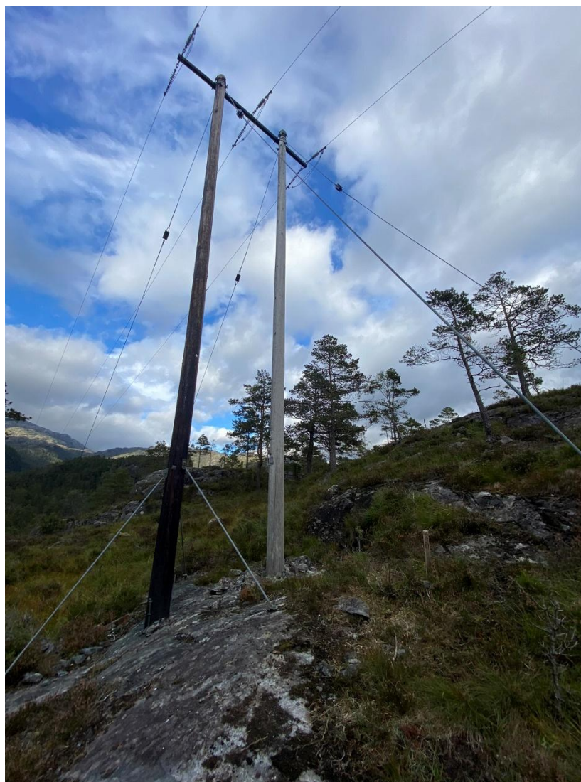
132 kV kraftledning Storbjørnlistølen–Tysse
