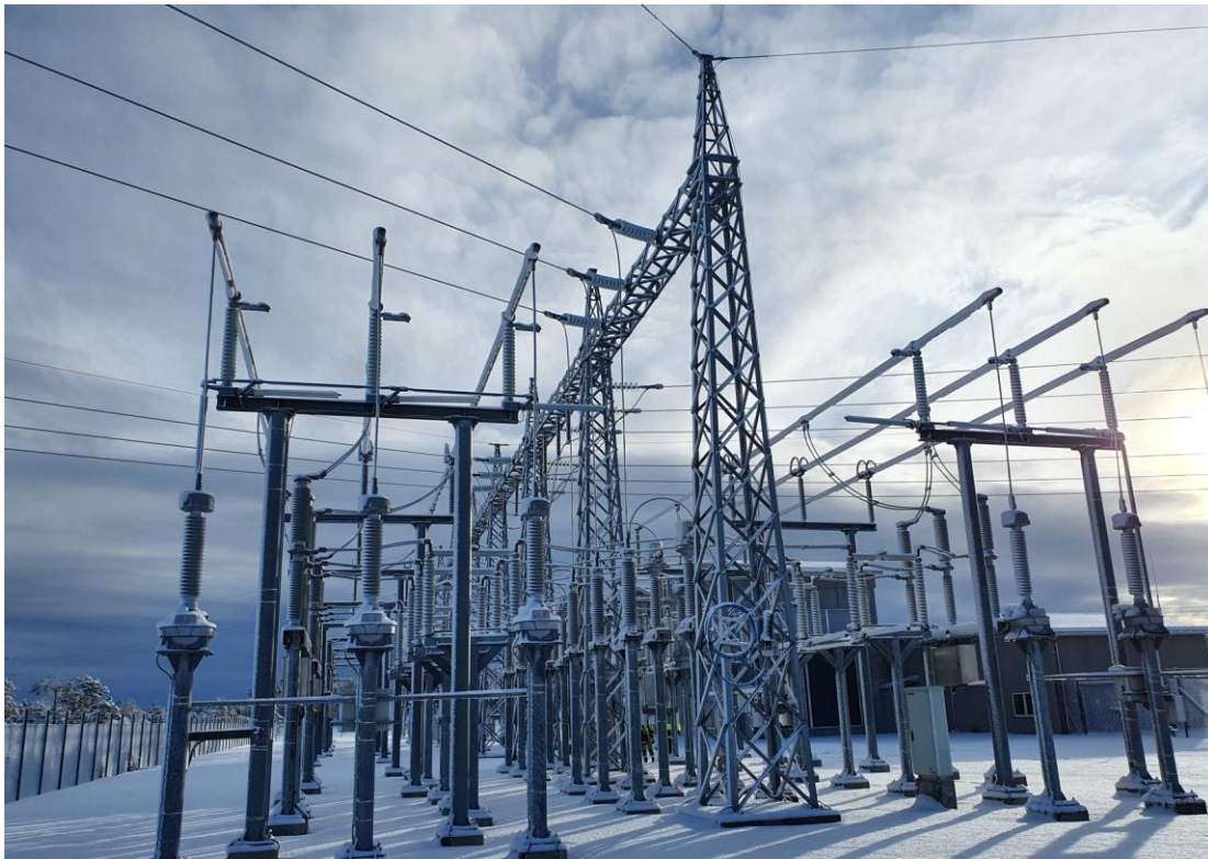
Figur 37: Eksempel på en luftisolert transformatorstasjon
