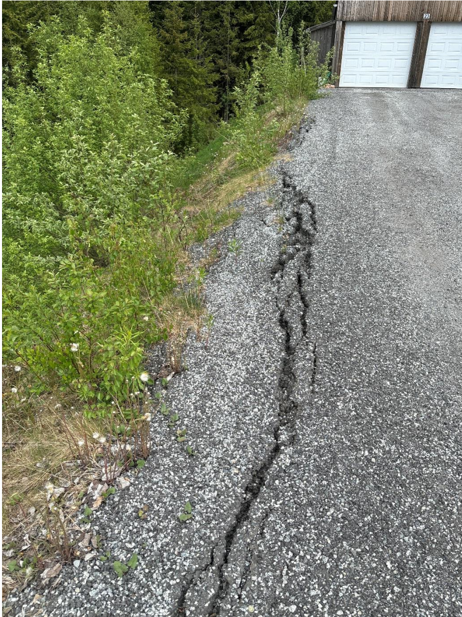
Figur 5: Bilde av infopunkt 4, ved Nedre Kolbotn 23 A, som viser at tegn til ustabilitet av underliggende skråning. Vegen er delvis sklidd ut. Skråning nedenfor har lav høyde og det er derfor ikke inntegnet faresone for denne skråningen.
