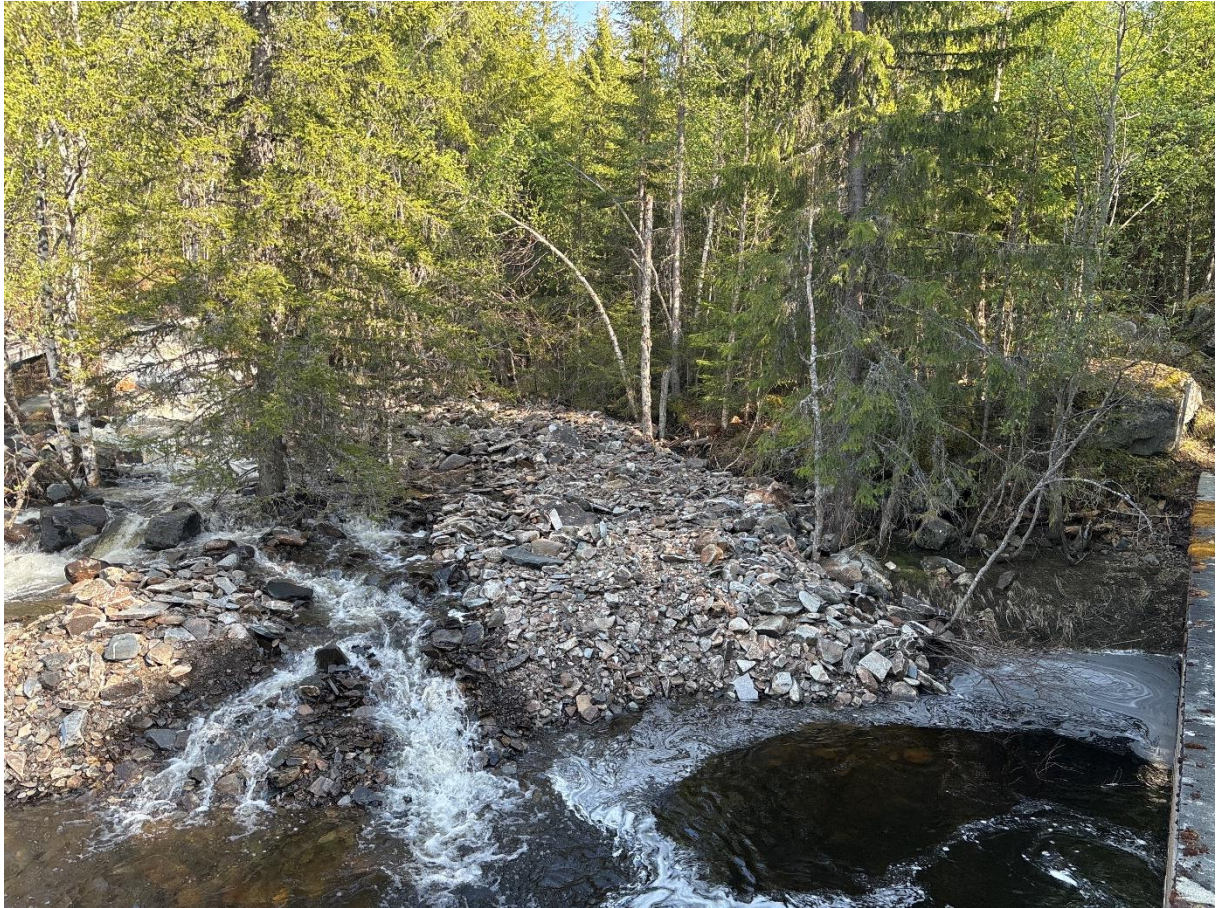
Figur 4: Bildet ser opp løpet, mot sør, fra dammen, kote + 612. Større mengder med relativt grove løsmasser har blitt avsatt. Trolig som følge av erosjon og massetransport i nyere tid.
