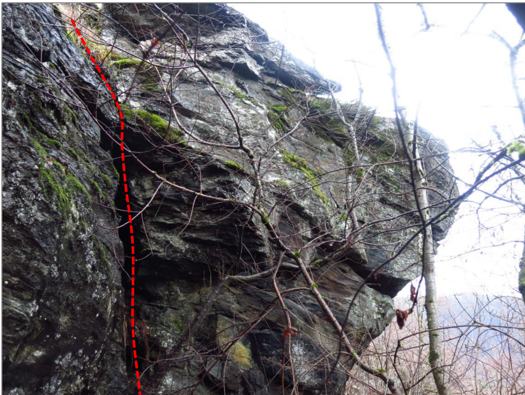
Bilde 15. Samme bergparti som i bilde 14. Bildet er tatt mot øst og viser tydelig den store sprekken i bakkant.
