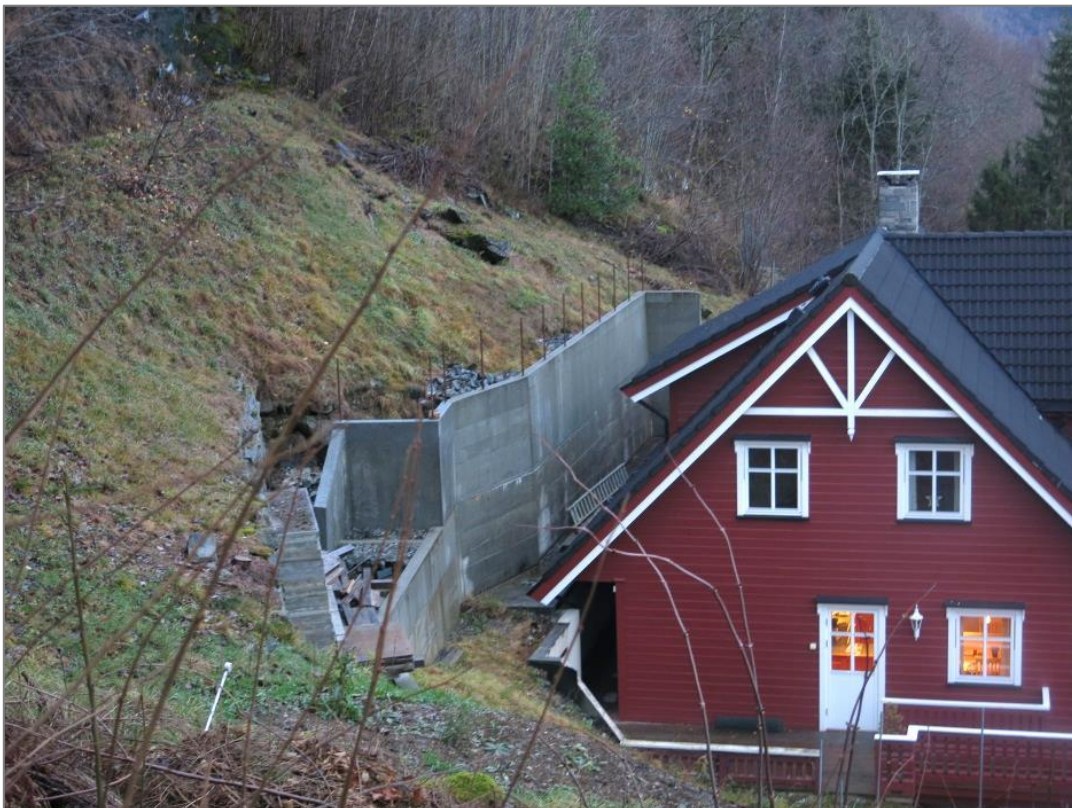
Bilde 11. Eksempler på eksisterende tiltak for å stabilisere skråninger i planområdet: betongmur bak huset ved Kongabergvegen 33. Dette er ikke tilstrekkelig for å sikre huset mot eventuelle steinsprang fra skråningen over, der det ligger flere løse blokker som kan gi nedfall mot tomten ved ekstremnedbør og frost-tineprosesser.
