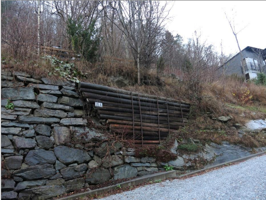
Bilde 10. Eksempler på eksisterende tiltak for å stabilisere skråninger i planområdet: sognemur ved Kongabergvegen 35.
