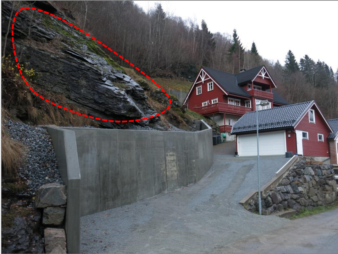
Bilde 12. Eksempler på eksisterende tiltak for å stabilisere skråninger i planområdet: betongmur ved parkeringsplassen ved Kongabergvegen 33. Vi anbefaler at bergpartiet på oversiden av tilkomstveien sikres med bolter.
