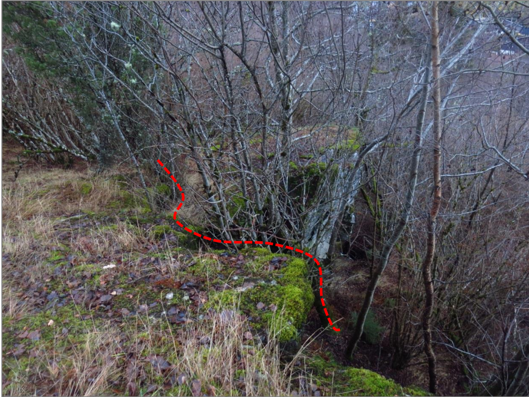
Bilde 18. Ustabil bergparti med en tydelig sprekk i bakkant.
