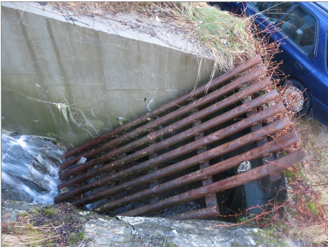
Bilde 9. Bekken lengst vest i fjellsiden som ledes inn i et fast bekkeløp med fangrist.
