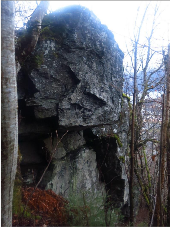
Bilde 20. Avløste bergblokker i samme skrenten som i tidligere bilder.
