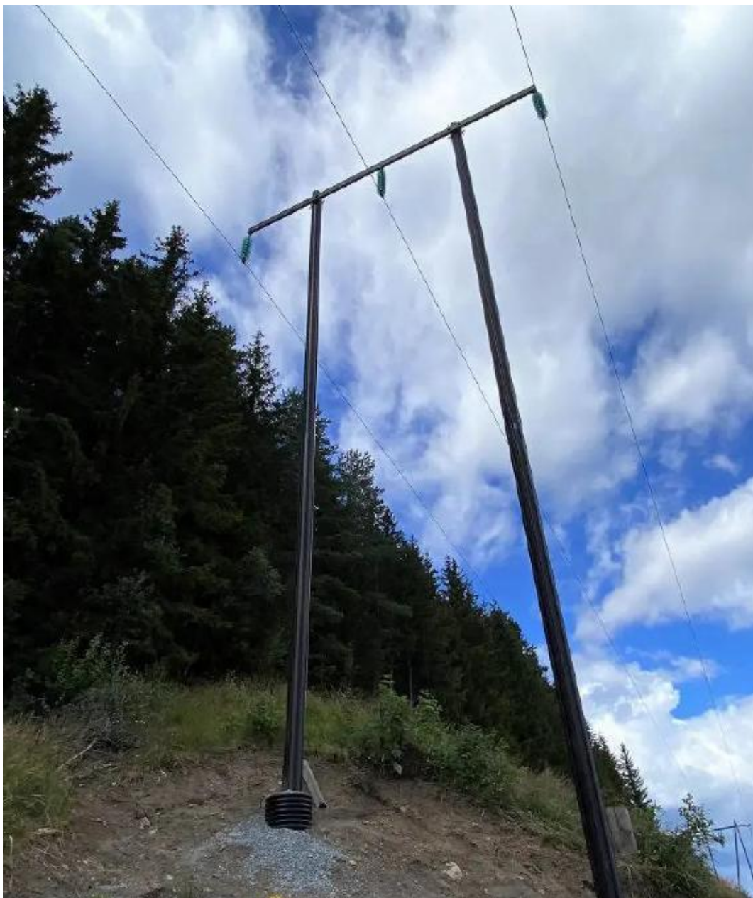
Figur 2-8. Avbildet mast i eloksert aluminium. Denne er brunere i fargen, og passer visuelt sett godt inn i terrenget i sommerhalvåret. Bilde: AluMast System
