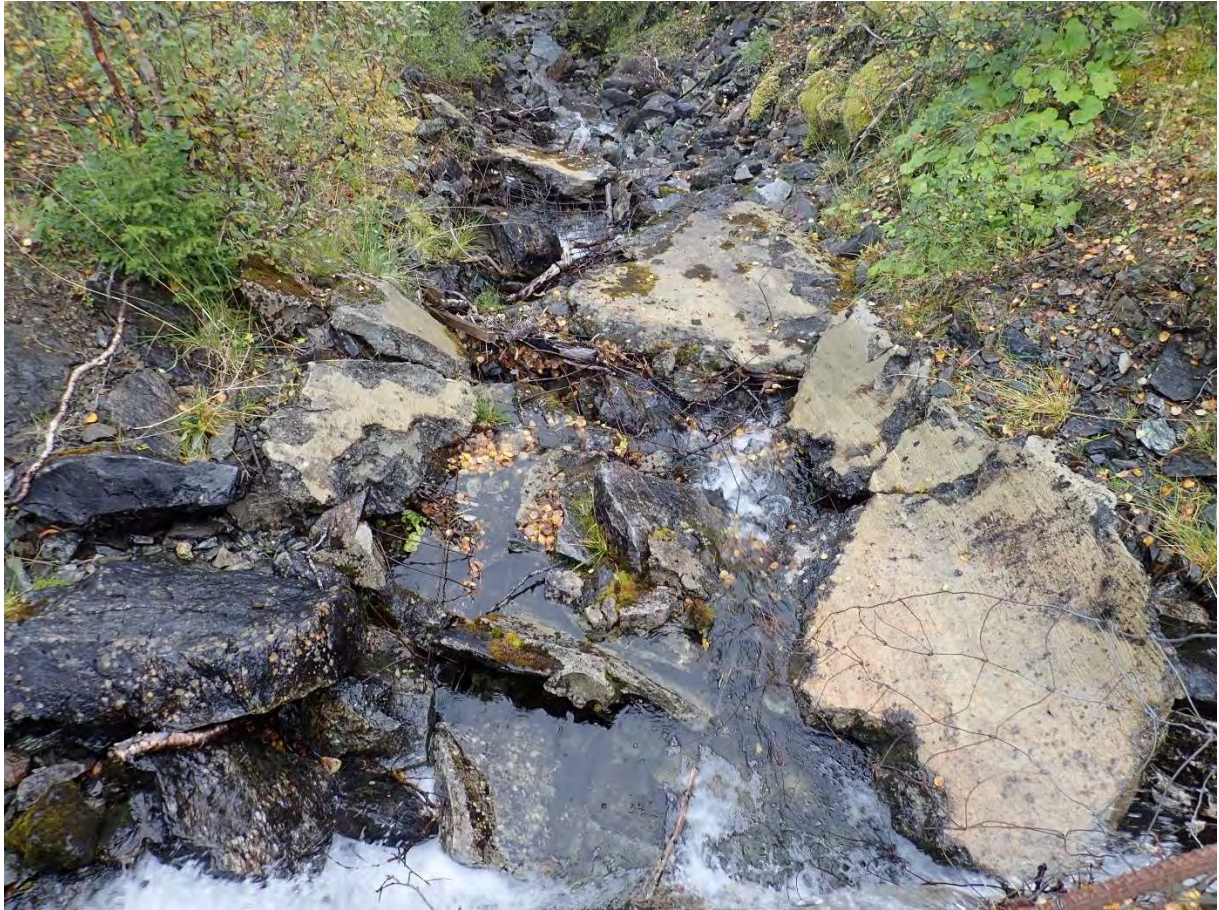
Figur 15. Nedstrøms overløp-rester betongplate.
