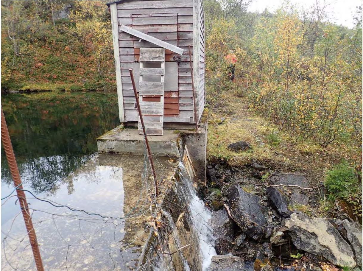
Figur 7. Overløp og ventilhus.
