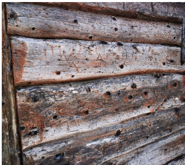
Figur 4-10: Skriblerier på ytre vegger på stølsbygning.
