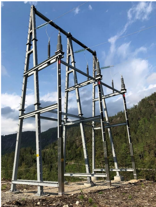
Figur 1-17. Bildet viser en kabelendemast. En slik kabelendemast er planlagt ved Såheim og sør for Svineroivegen, der den ledningen Mår-(Såheim)-Vestfjorddalen går fra luftledning til jordkabel.
