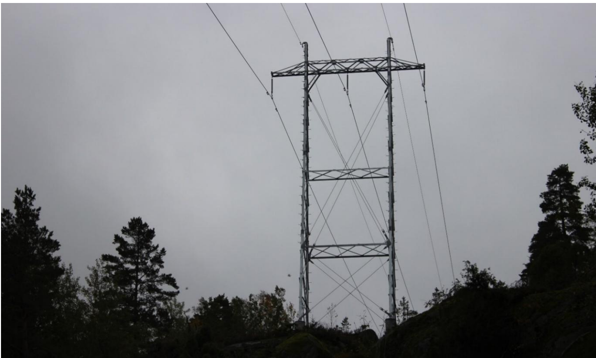
Figur 1-14. Bilde av 132 kV portalmast i stål med liner i horisontaloppheng.
