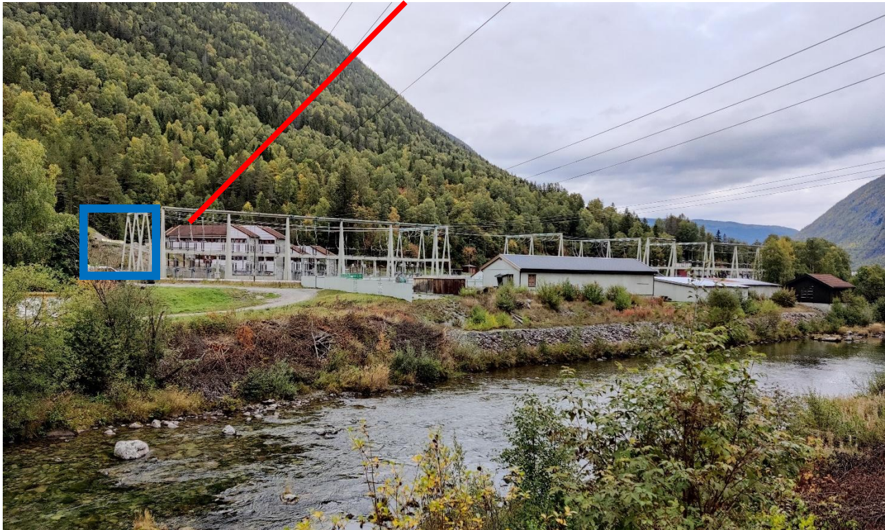
Figur 1-12. Mår kraftverk. Eksisterende innføring (132 kV Såheim-Mår) til Mår beholdes (rød linje). Blå markering viser utvidelse av eksisterende 132 kV utendørsanlegg ved Mår kraftverk med et felt vestover. Bildet er tatt i retning nord.
