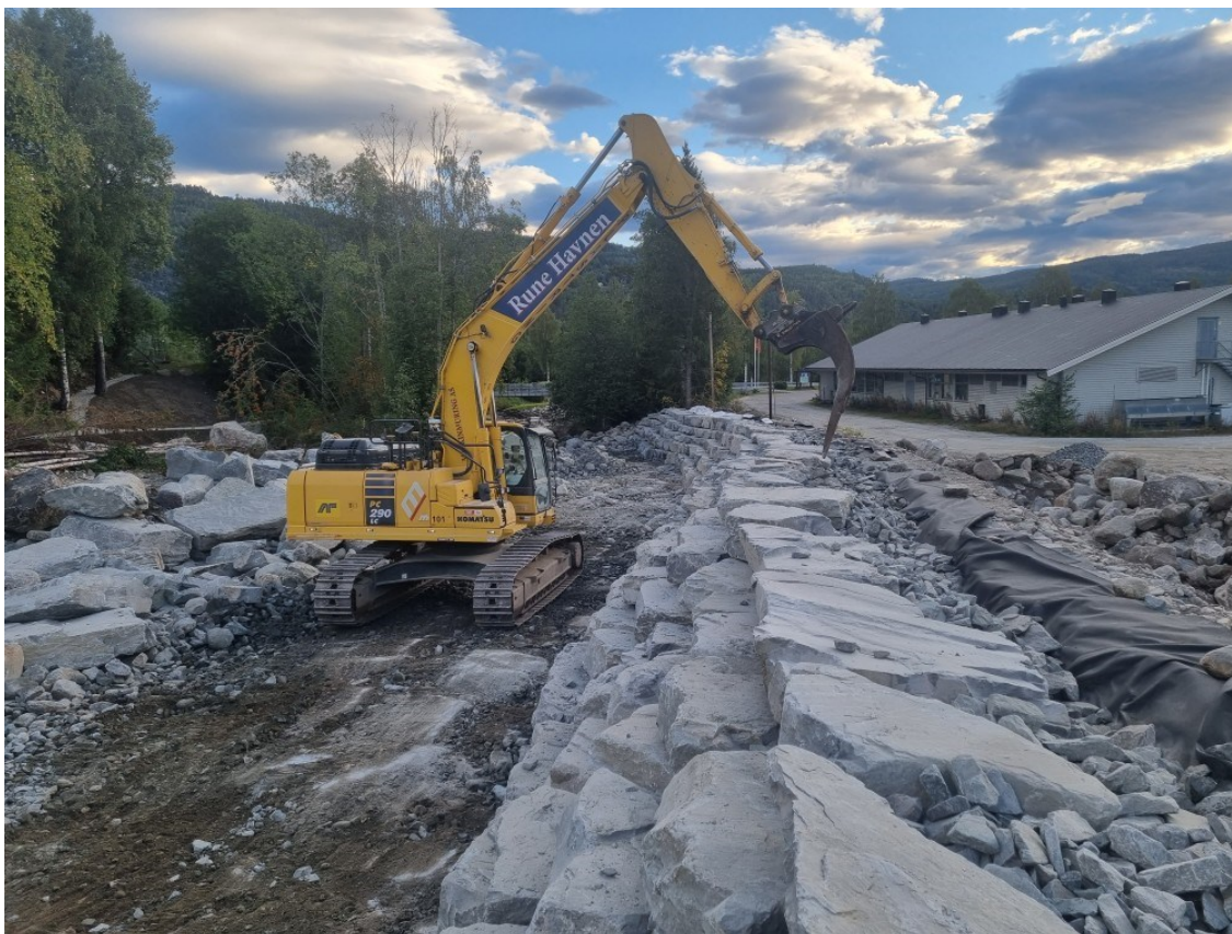
Figur 9-7 Eksempel på erosjonssikring med «trapping»/tørrmuring fra tidligere prosjekt. Bakom «trappene» finnes pukk og fiberduk.
