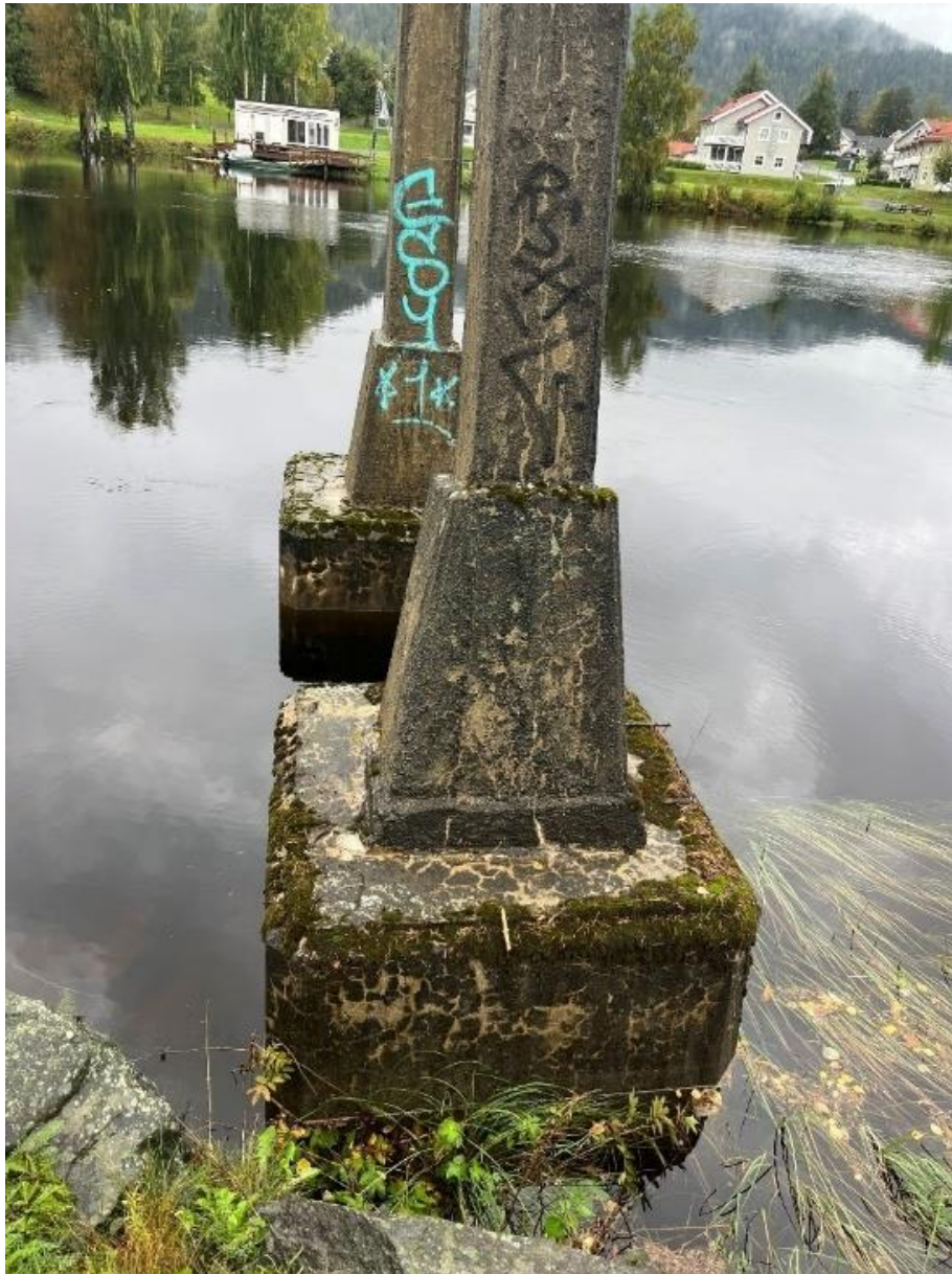
Figur 3-12: Mastepunkt 26 står i elven og skal fjernes. (Foto: Rambøll)
