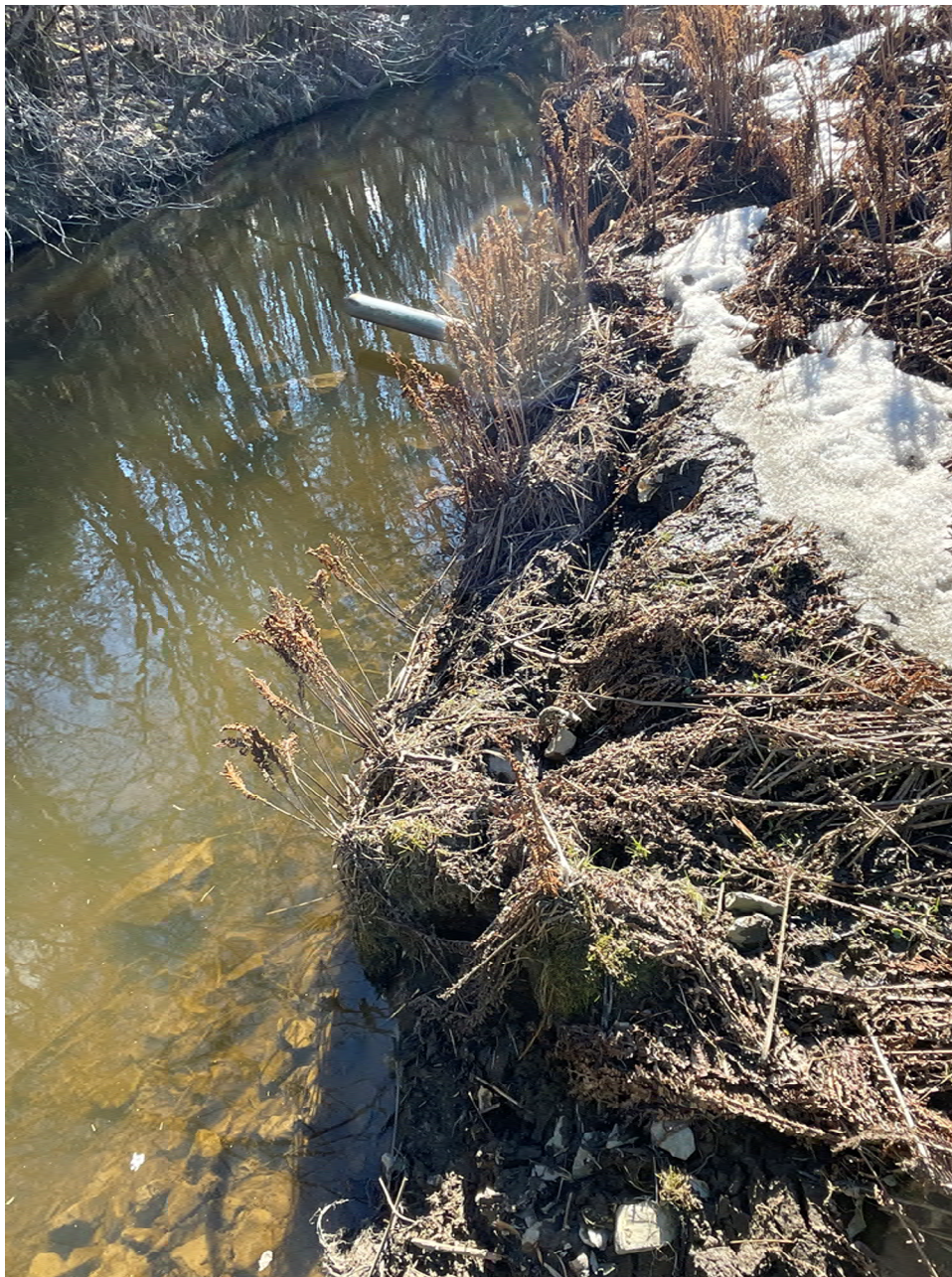
Figur 1-12. Grunn sprekk i overflaten langs skråningskanten tyder på at elvekanten eroderes og sklir ut (langsgående). Relativt slakt terreng mot vest. Klassifiseres med «noe erosjon». Se punkt 11 i kart for plassering.
