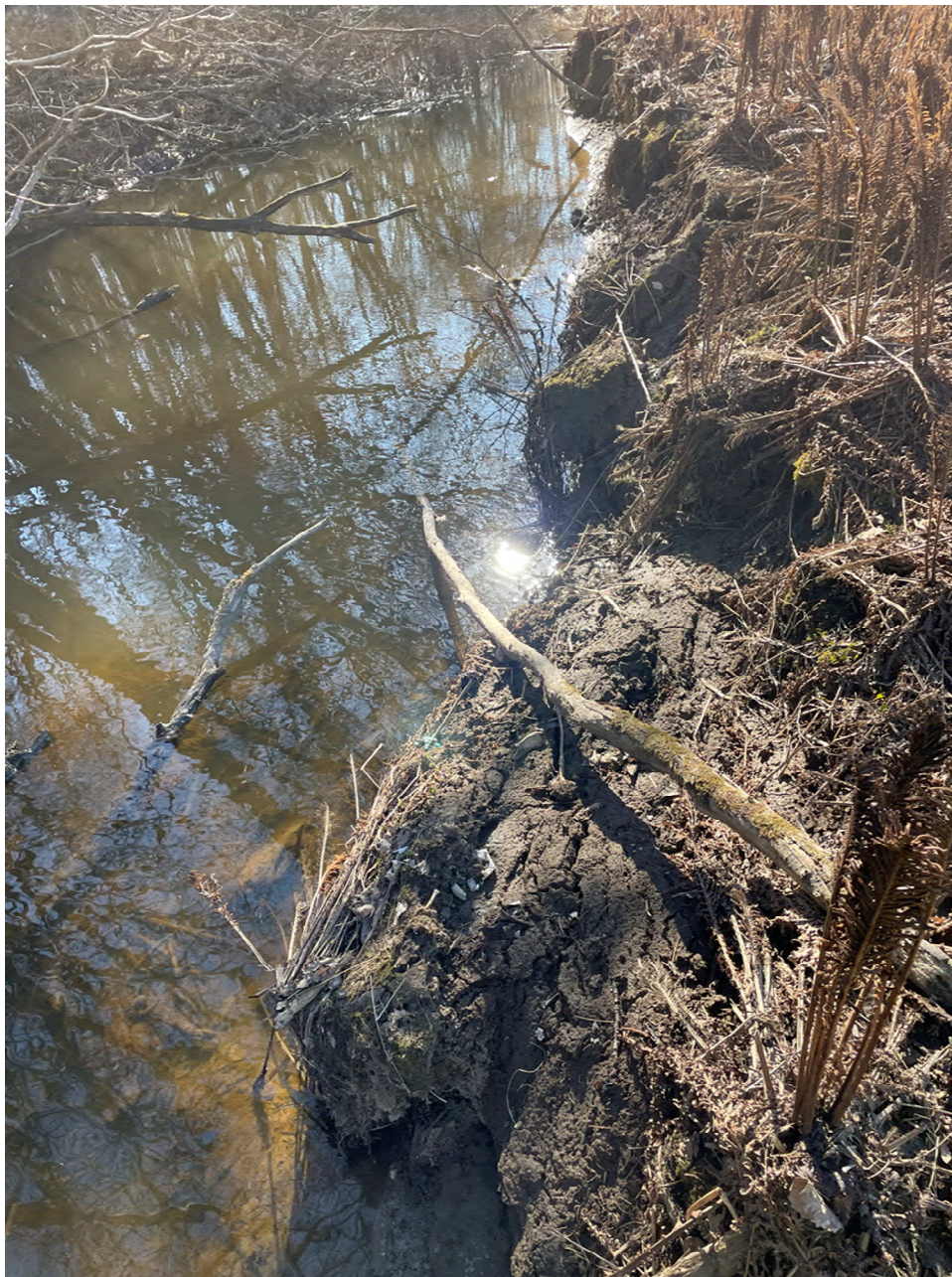
Figur 1-13. Elvebredden har glidd ut på vestsiden av elven. Aktiv erosjon i kohesjonsjordarter fortsetter sørover langs elveløpet på vestsiden av elven. Klassifiseres med «noe erosjon». Bilde er tatt ved punkt 12, og erosjonsforholdene fortsetter bort til punkt 13.
