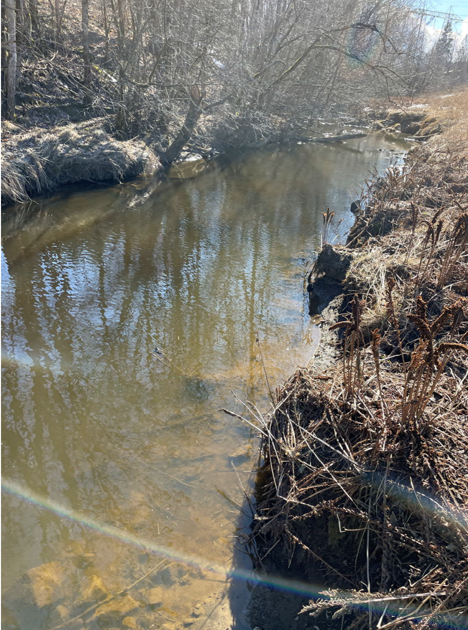
Figur 1-11. Ingen naturlig erosjonsbeskyttelse langs vestsiden av elveløpet. Blottet leirskråning med brede langsgående overflateutglidninger sørover langs elven. Pågående sprekkdannelse langs elvebredden (vestsiden) tyder på at overflateutglidning pågår. Farget vann tyder på aktiv erosjon. Klassifiseres med «noe erosjon». Se punkt 10 i kart for plassering.
