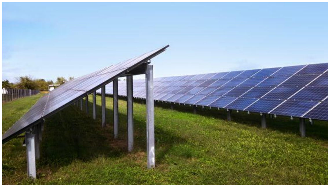
Figur 3-3: Eksempel på fast-vinkel installasjonsløsning (foto: Willowbrook Solar)
