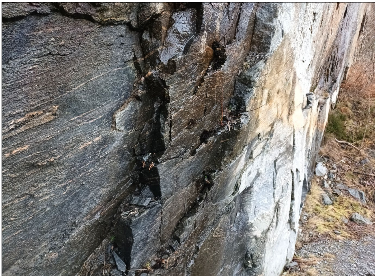
Figur 20: Det oppknuste partiet ved stien ned til kaia (infopunkt 2) er oppstykkka i mindre steinar ( <0,1 \text{ m}^3 ) og ein kunne rive dei laust frå fjellet med handmakt under synfaringa. Grunna den høge oppknusinga vil utrasingar bestå av små steinar og grus utan skadepotensiale. Infopunkt 2.
