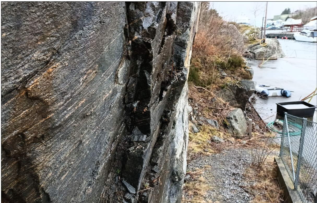
Figur 8: Oppsprukke parti i nordaustleg del av kartlagt område, langs stien som går ned til kaia. Partiet er laust og kan fjernast med handkraft. Partiet dannar eit om lag 10 cm tjukt flak, og fjellet bak framstår som massivt. Oppknusingsgrada er høg som kan føre til små utrasingar av stein og grus på stien.
