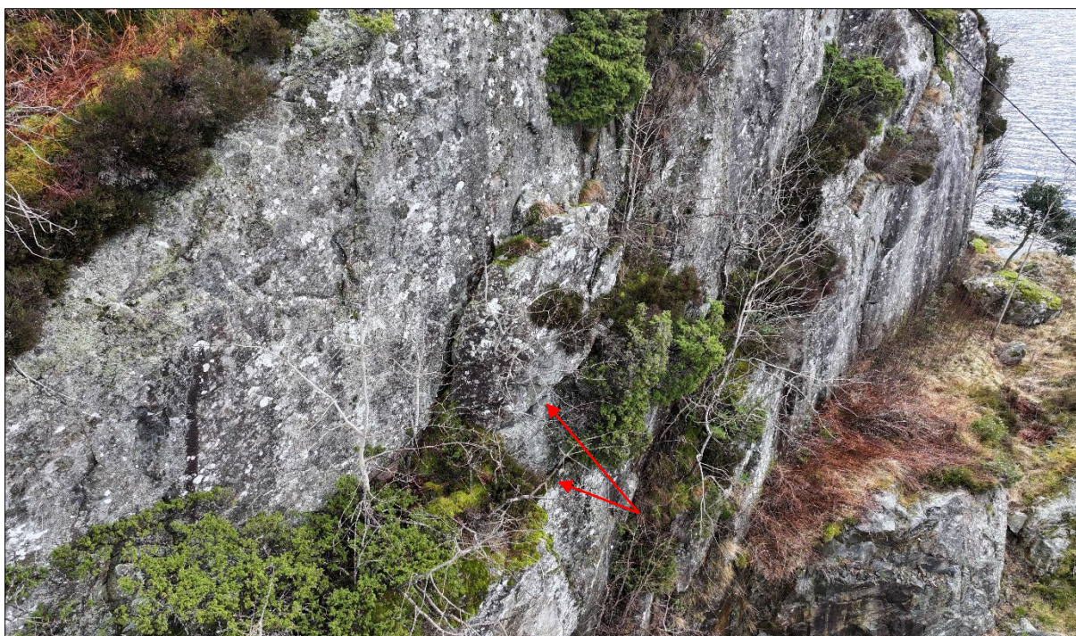
Figur 21: Blokka ved infopunkt 3. Bilete viser at det er sprekkdanning i underkant og bakkant, og at blokka er todelt (raud pil). Det er antatt at det har vore lite til ingen bevegelse i blokka, sjølv ikkje under sprengingsarbeidet i 2013 -2015. Det er antatt at sprekkplanet i bakkant ikkje er gjennomgåande, og at den har feste i fjellet.
