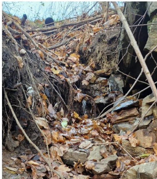
Bilde 2, erosjonsgrop ved utløpet av stikkrennene
