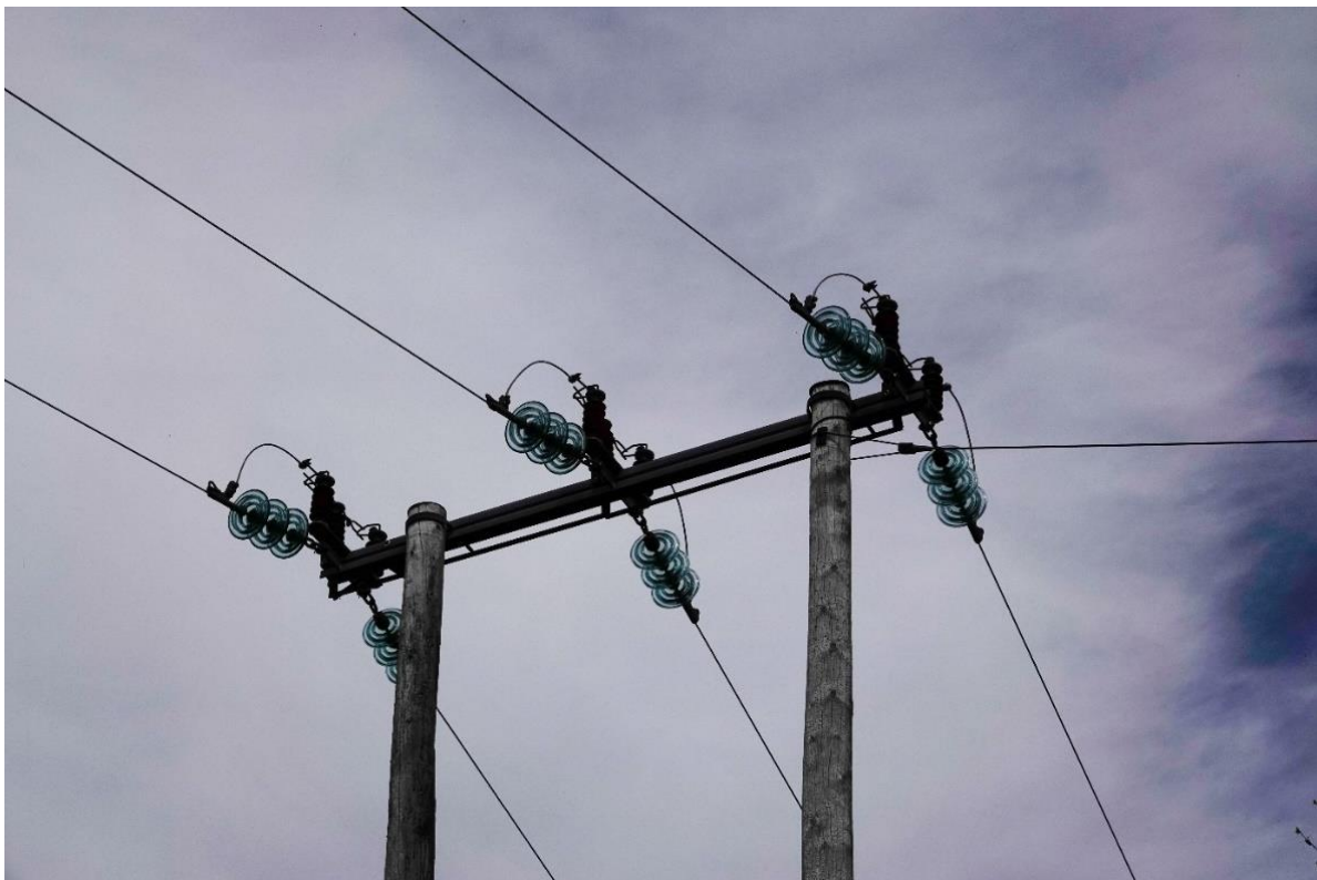
Bilde 4.4. Stolpe i hubroens territorium ved Innvordfjellet. Denne har metall-travers, noe som øker sjansen for elektrokusjon fordi avstanden mellom kraftførende ledning og jord blir kort. Foto: Magne Husby
