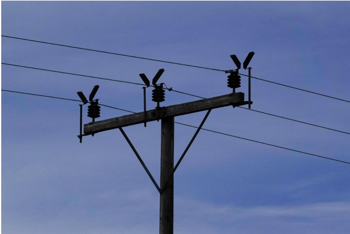
Bilde 4.3. En av stolpene i 22 kV-nettet ikke alt for langt fra hubroens hekkeplass ved Innvordfjellet. Det stikker opp plastvinger som gir selvslukkende gnistgap over ledningene (se mer på http://www.el-tjeneste.no/files/Brosjyre-gnistgap.pdf ). Foto: Magne Husby
