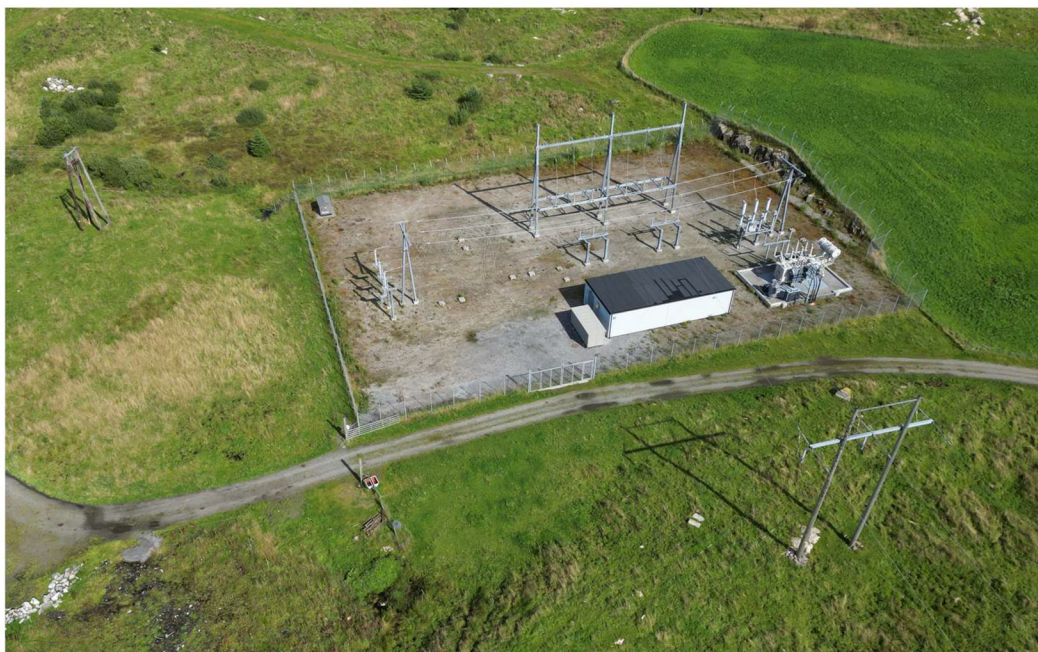
Figur 2. Sandøy transformatorstasjon slik den fremstår i dag. Fotoet er tatt fra sør mot nord. Masten nede i høyre hjørne er første mast mot Mongstad. Foto: BKK.
