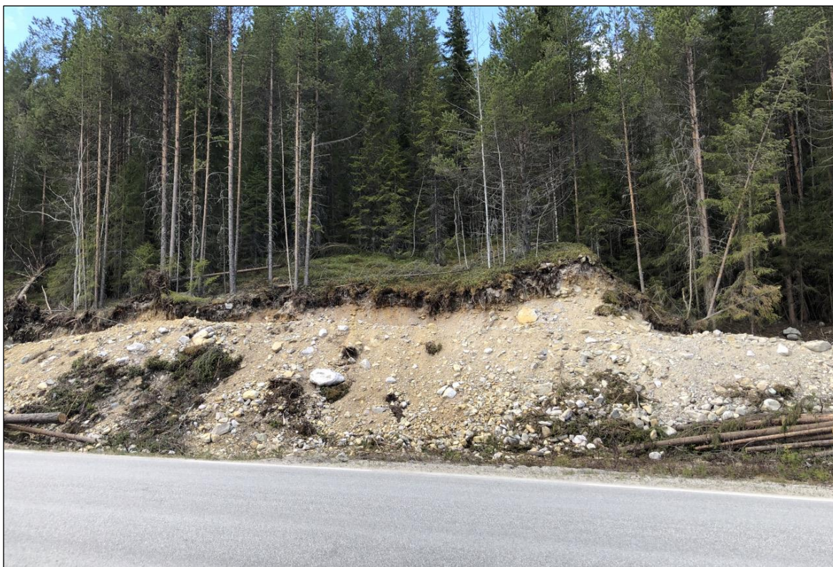
Figur 9: Løsmasseskråning på oversiden av Hanestadvegen ved Tømmerdalen.
