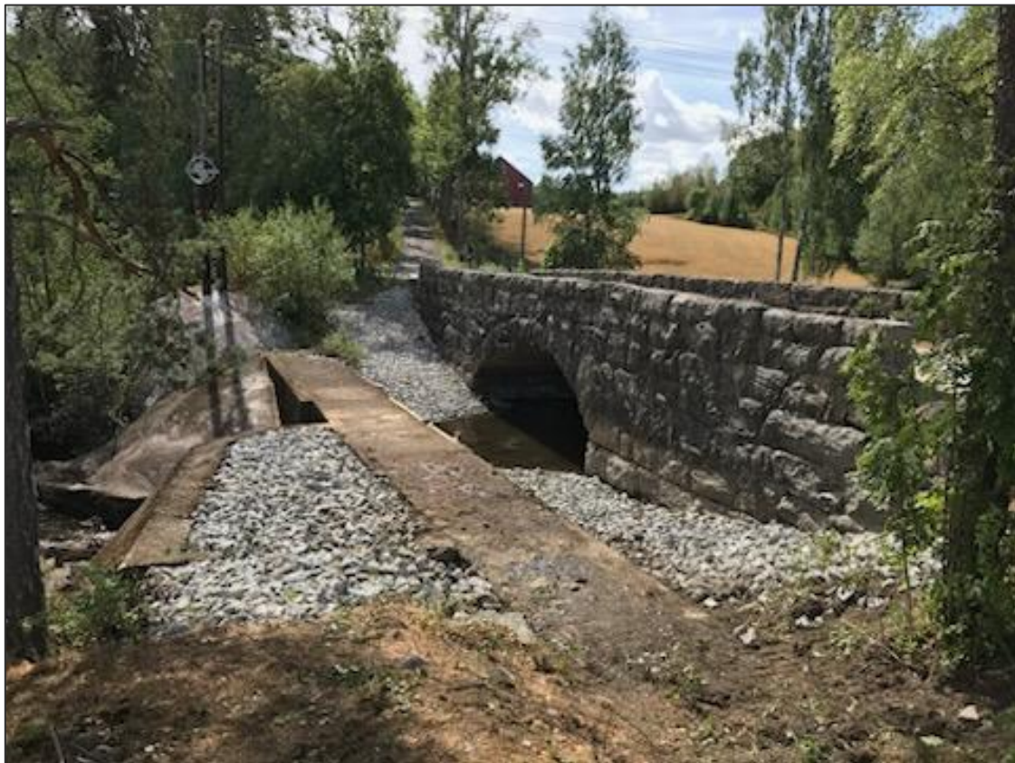
Figur 9-1 - Terskelsituasjon i 2018 (før kappestøp ble utført)
