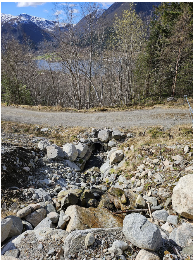
Bilde 7: Bekkeløp i stikkrenne under Tomrefjellsvegen. Stikkrennene er ikke dimensjonert for å tåle store vannmengder og er sårbare for tetting av løsmasser og vegetasjon.
