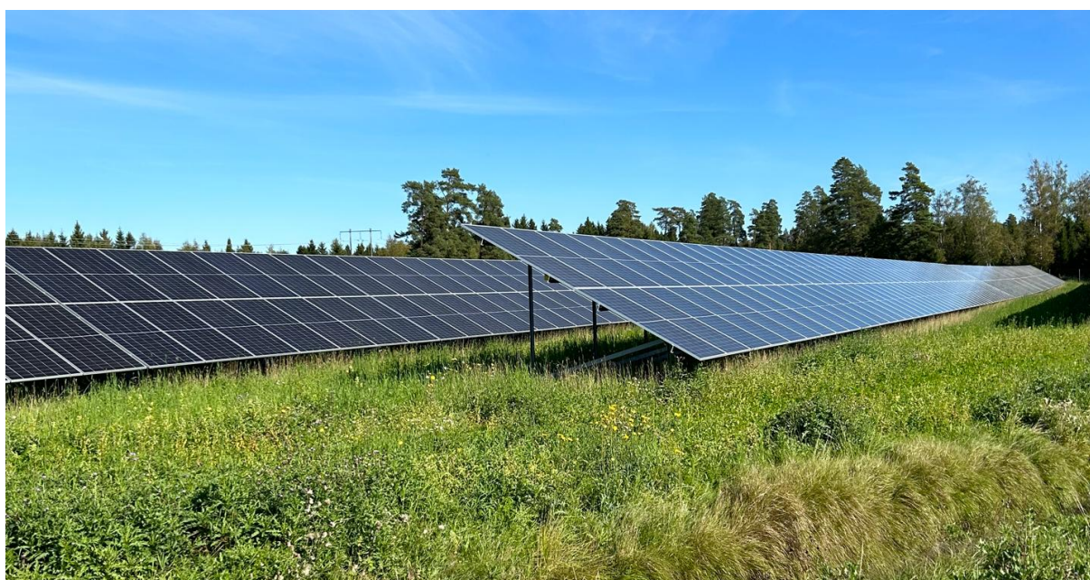
Figur 7 - Solcellepaneler montert i portrett
