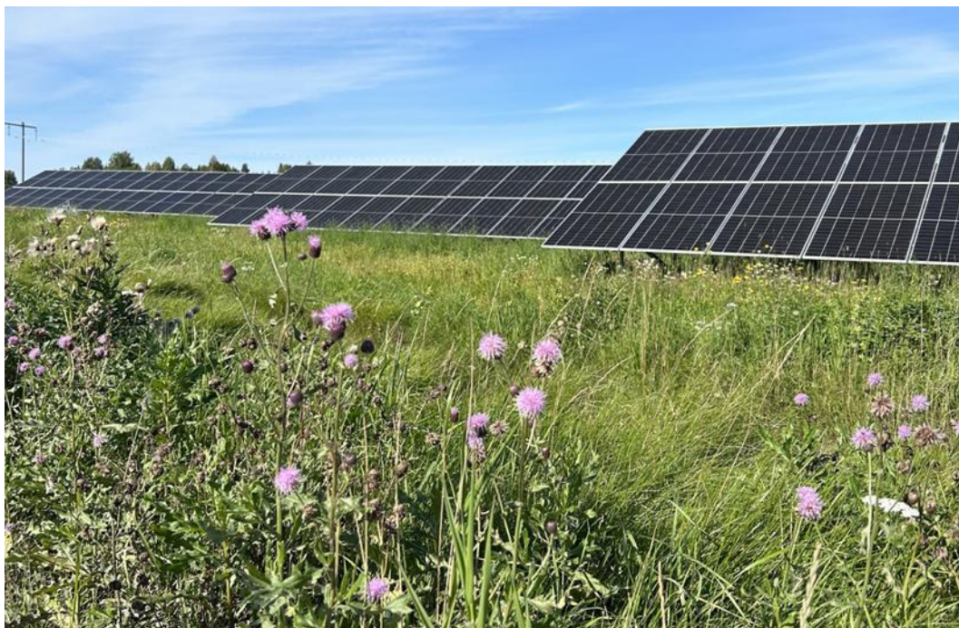
Figur 22 - Vegetasjon i solkraftverk sommeren etter bygging
