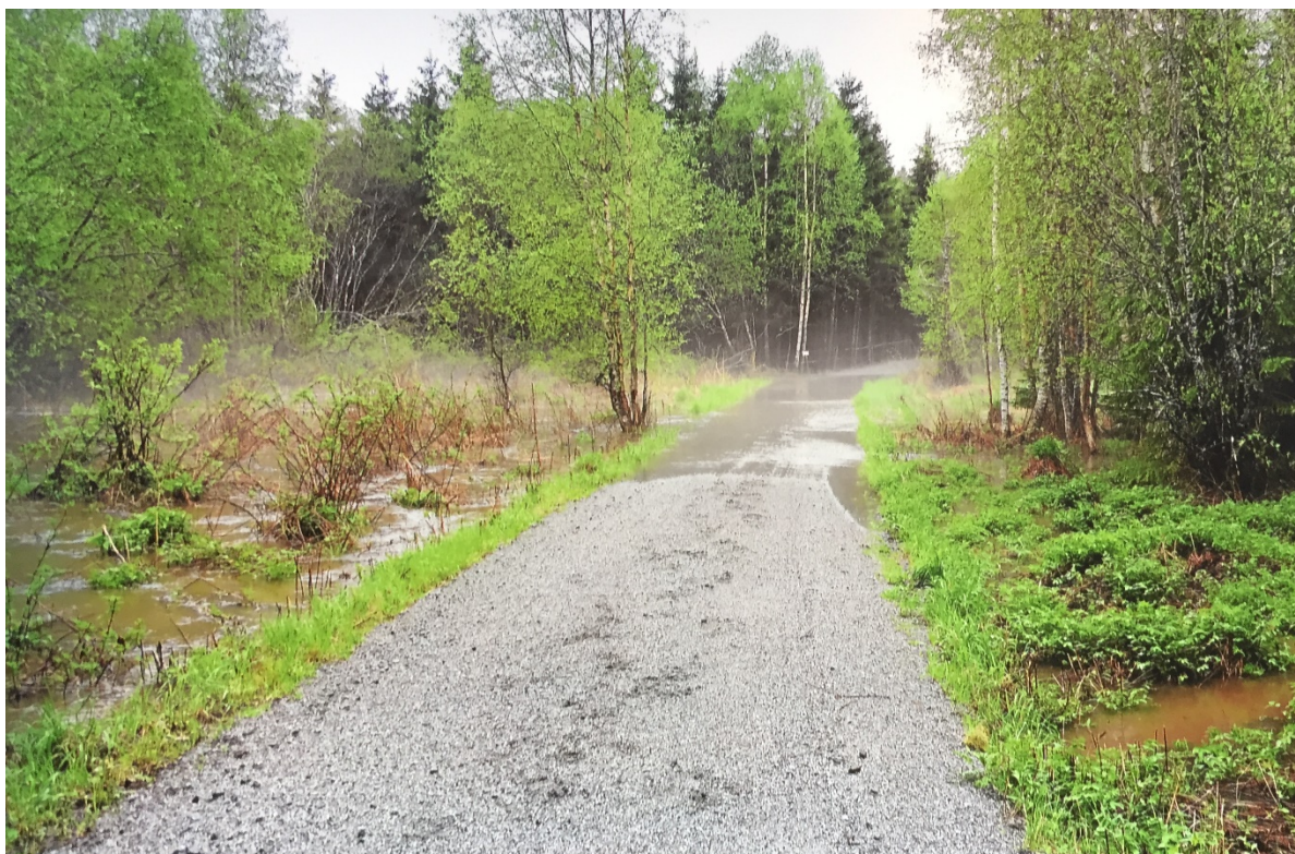
Figur 18. Stående flomvann ved skogsområdet ca. ved modellens tverrprofil 1156. Bilde tatt mot vest. Foto: Tor Harald Tusvik, 23.05.2016
