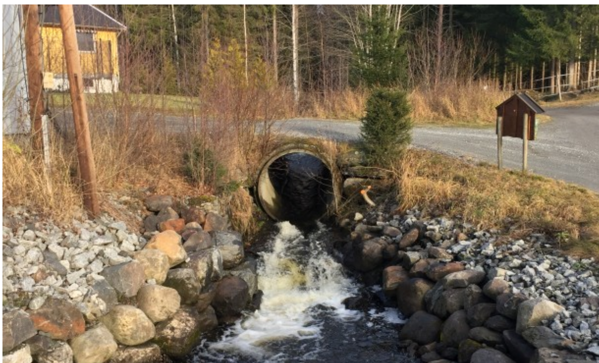
Figur 10. Kulvertkryssing ved modellprofil 915. Diameter 1500 mm. Bilde mot øst. Foto: Asplan Viak, 09.11.2017.
