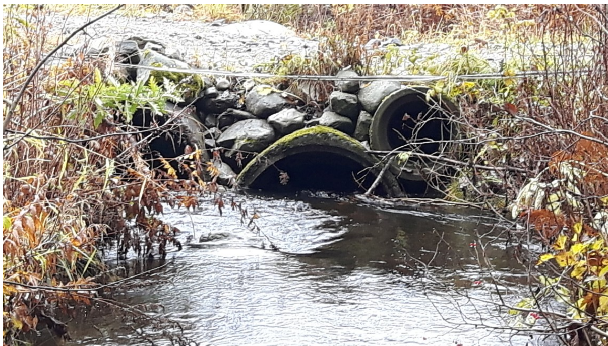
Figur 9. Kulvertkryssing ved modellprofil 935. Bilde fra oppstrøms side mot vest. Diameter 500, 900 og 1000 mm. Foto: Hamar kommune, 25.10.2017
