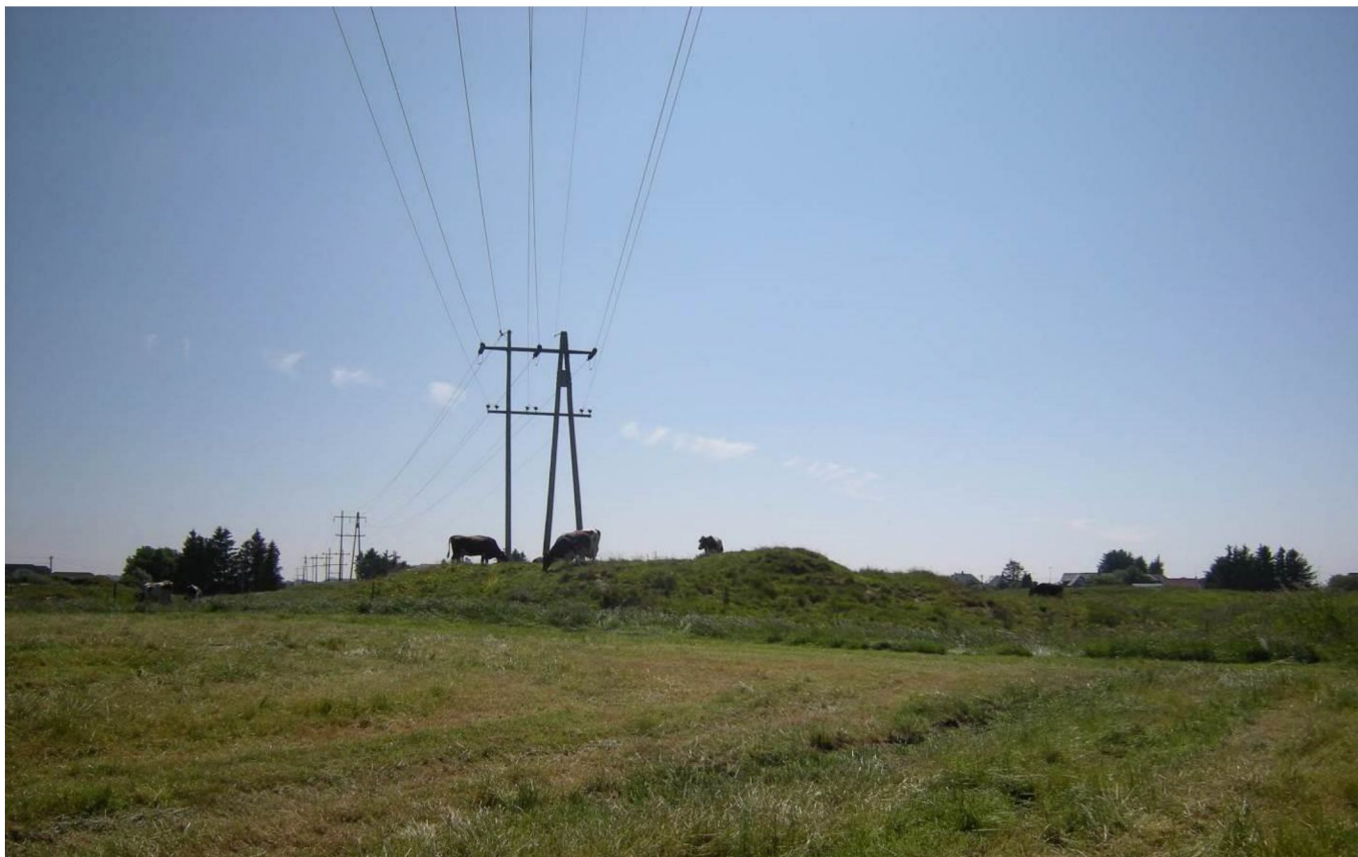
Foto av eksisterende 66 kV kraftledning Bø – Meland. 22 kV ledning henger på traversen under. Bildet tatt fra nord mot sør like vest av Avaldsnes.
