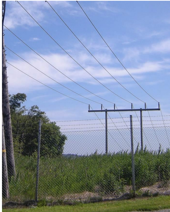
Foto 3. 66 kV ledninger, innføring mot Bø transformatorstasjon
