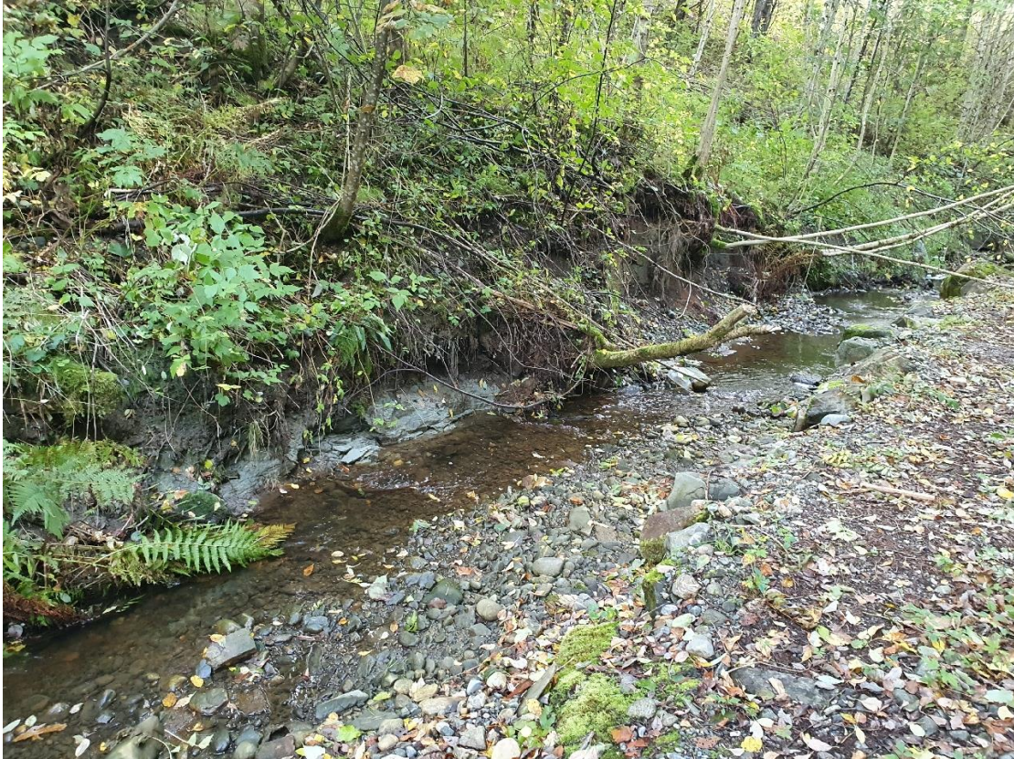
Figur 4-3: Bilde fra Uldegrova som viser blottlagt leire i bunn av skråningen mot øst. Erosjon pågår og mindre utglidninger har gått.
