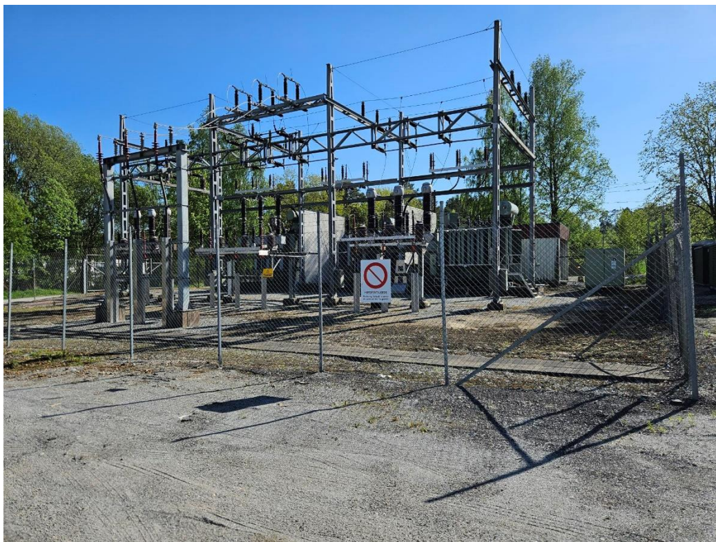
Figur 6: Bilde av nåværende Isebakke transformatorstasjon.
