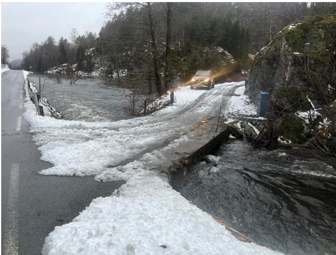
Figur 18: Bilde av vannføringen langs Fv44 ved innkjørsel til gårdsbrukene på Gumpefjell april 2023.
